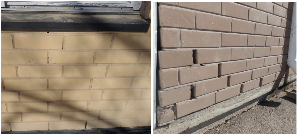
Kuvat 4.5 ja 4.6. Tiiliverhouksen halkeamien mittasuhteet voivat vaihdella suuresti. Kuvat: J. Parkkinen, FCG Suunnittelu ja Tekniikka Oy.
