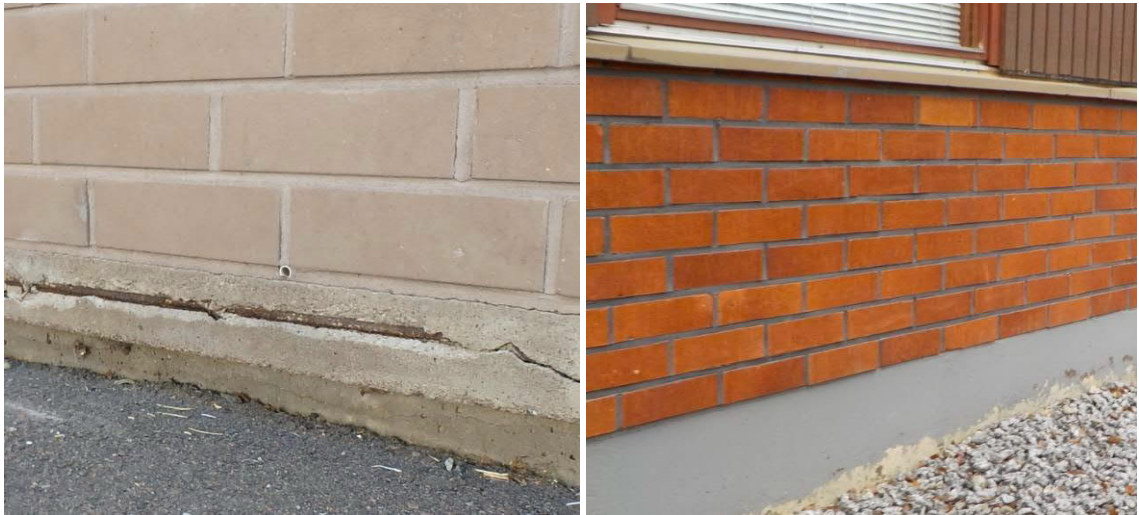
Kuvat 4.3 ja 4.4. Tuuletusrakoon johtavat tiiliverhouksen alaosan tuuletusaukot voivat tuulettumisen suhteen olla kooltaan riittämättömiä tai puuttua kokonaan. Molemmat seinärakenteet ovat alkuperäisten suunnitelmien mukaan tuuletusraollisia. Kuvat: J. Parkkinen, FCG Suunnittelu ja tekniikka Oy.
