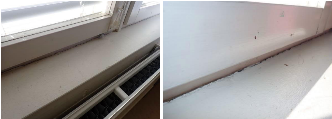
Kuvat 4.9 ja 4.10. Tiili-villa-tiili –ulkoseinärakenteelle tyypillinen ilmavuotoreitti ikkunan apukarmin ja sisäkuoren välissä. Kuvat: J. Parkkinen, FCG Suunnittelu ja Tekniikka Oy.
