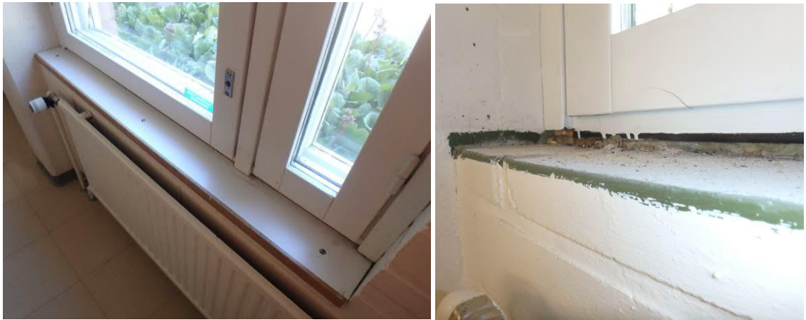
Kuvat 4.7 ja 4.8. Ilmavuotoreitti ikkunakarmin ja ikkunalaudan välistä. Oikeanpuoleisessa kuvassa ikkunalauda on poistettu. Kuvat: J. Parkkinen, FCG Suunnittelu ja Tekniikka Oy.
