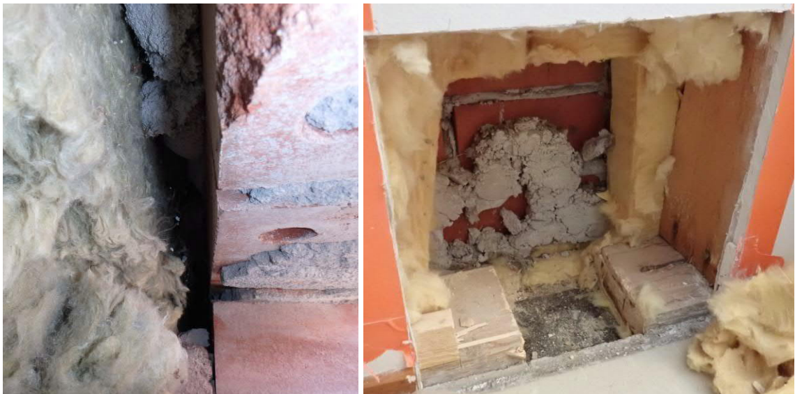
Kuvat 4.1 ja 4.2. Huolimattoman ulkoverhouksen muuraustyön seurauksena laastipurseet ovat pudonneet tuuletusraon alaosiin heikentäen ilmanvaihtuvuutta tuuletusraossa. Kuvat: J. Parkkinen, FCG Suunnittelu ja Tekniikka Oy.
