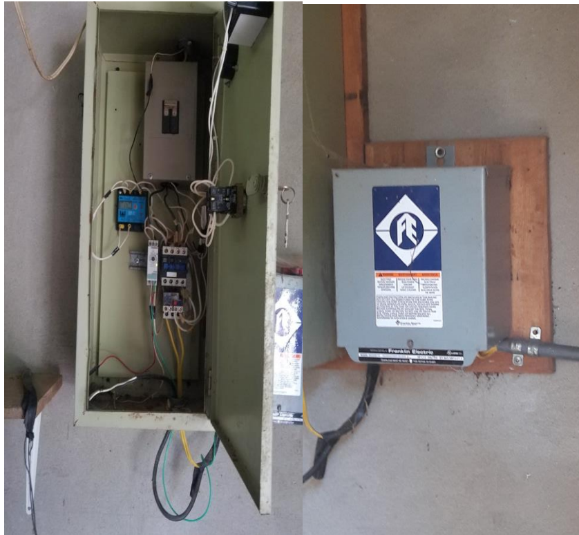
Sistema en caseta de control
