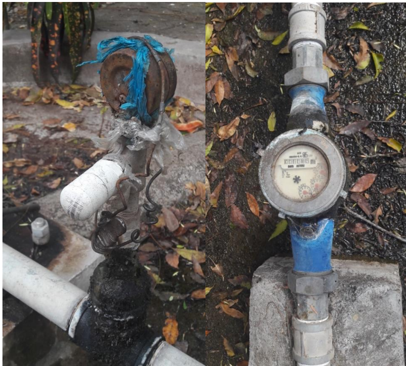
Sistema actual en mal estado
