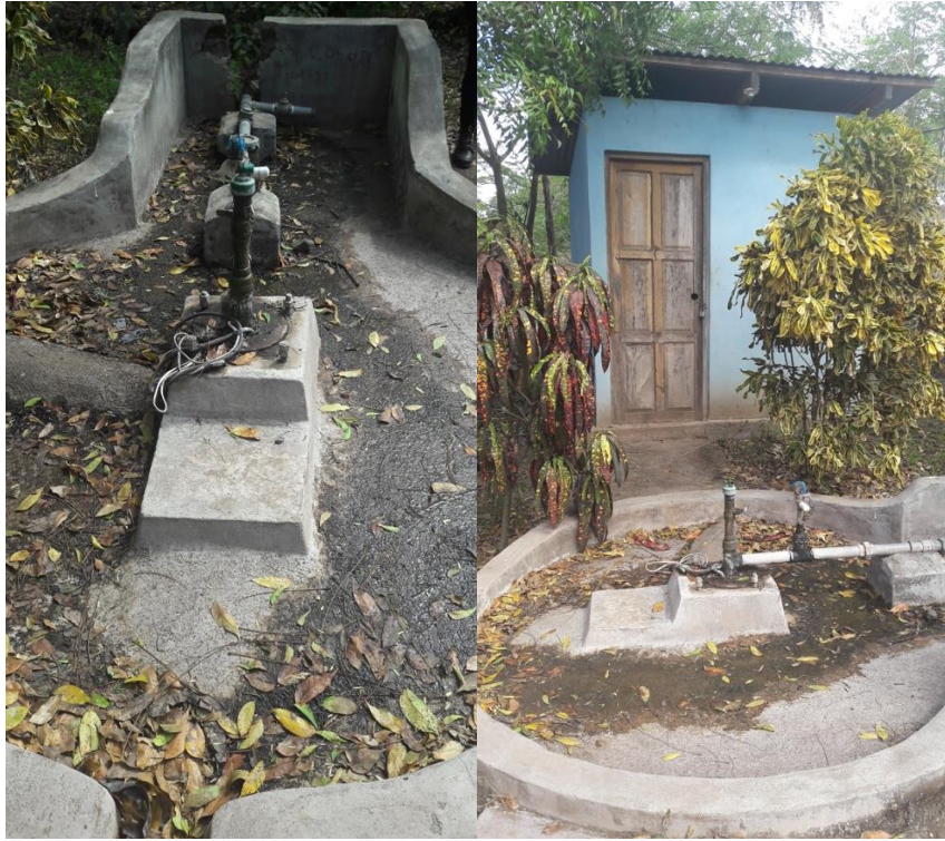
Sistema actual y caseta de control
