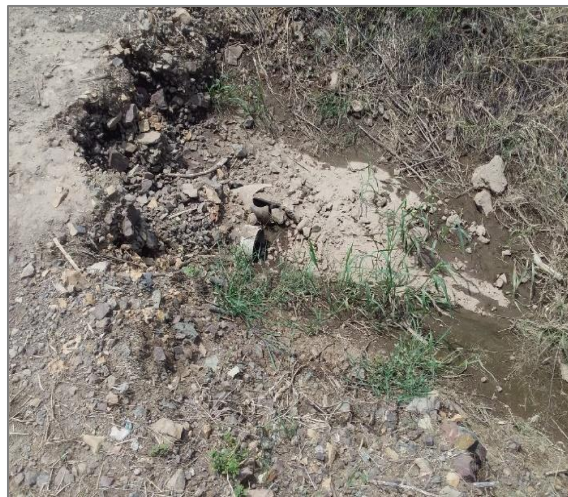
Fig. 12. Alcantarilla en trocha cañera
