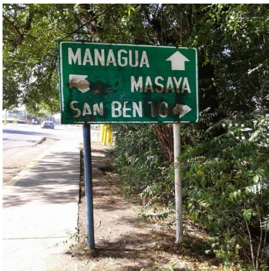
Ilustración 26. Señal Informativa, estación 21+794.3
