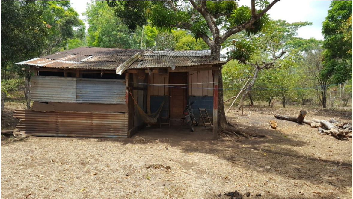
Foto 3 Situación actual de las viviendas de la Comunidad Nueva Jerusalen
