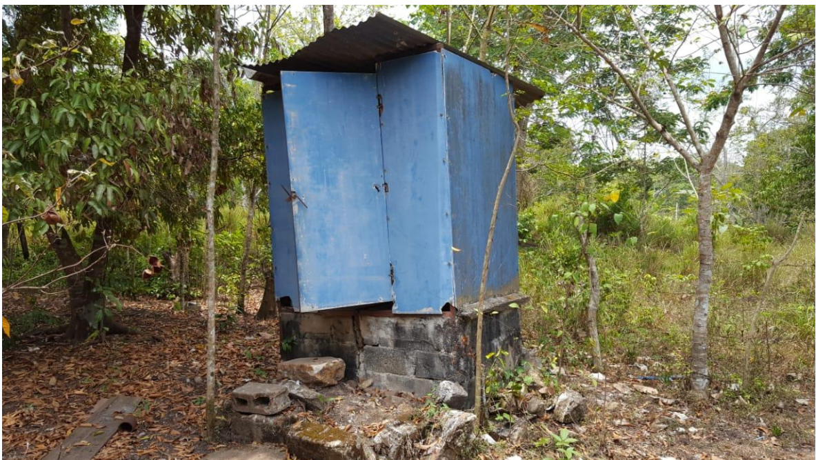
Foto 4 Situación actual de letrinas semi-elevada en mal estado en la comunidad Nueva Jerusalen
