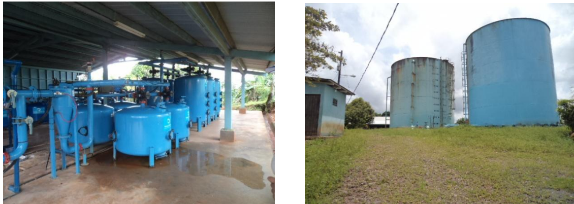
Figura 6. Planta de tratamiento y Tanques de almacenamiento
