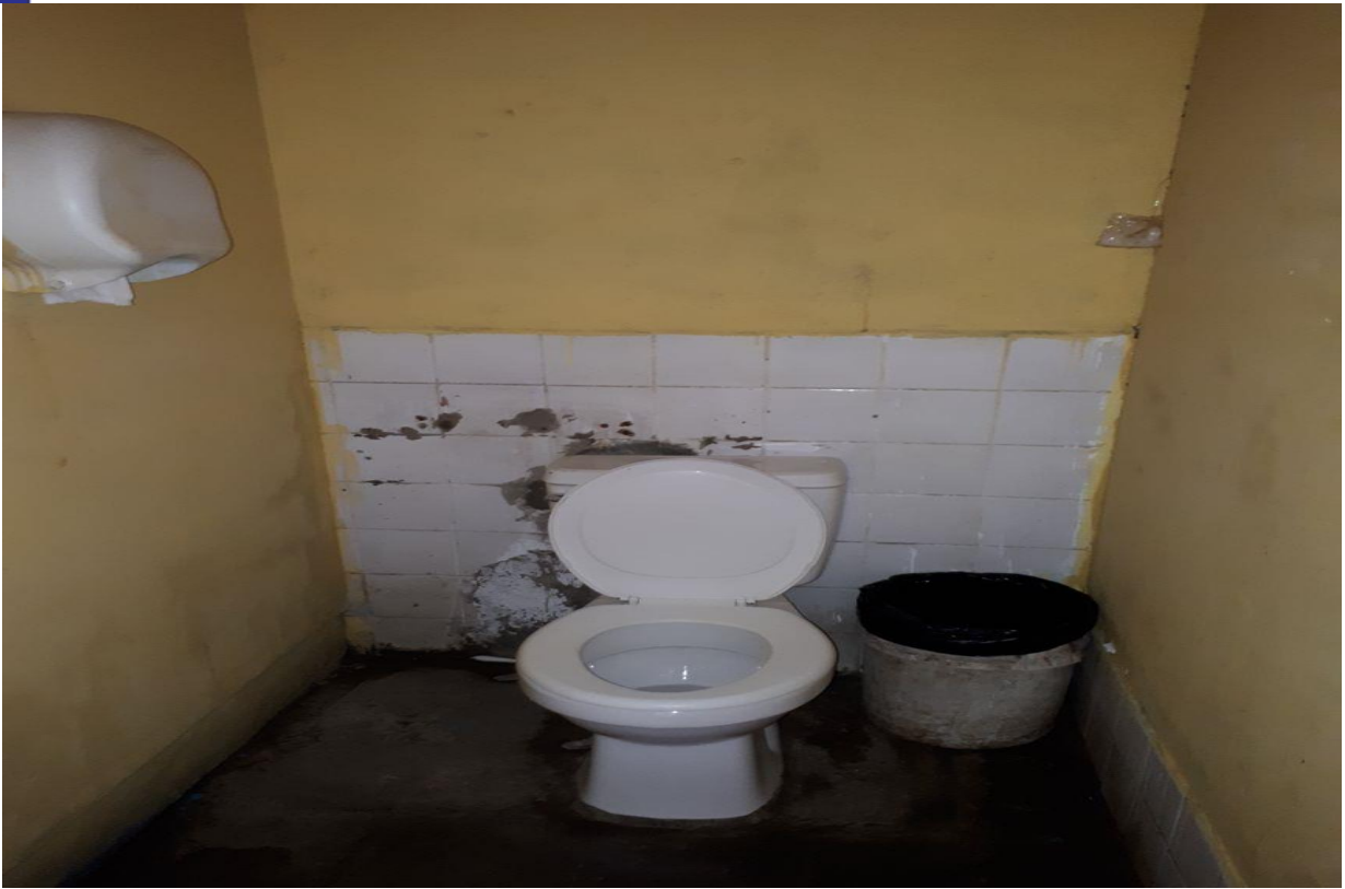
ANEXO 4: Servicios Higiénicos en malas condiciones
