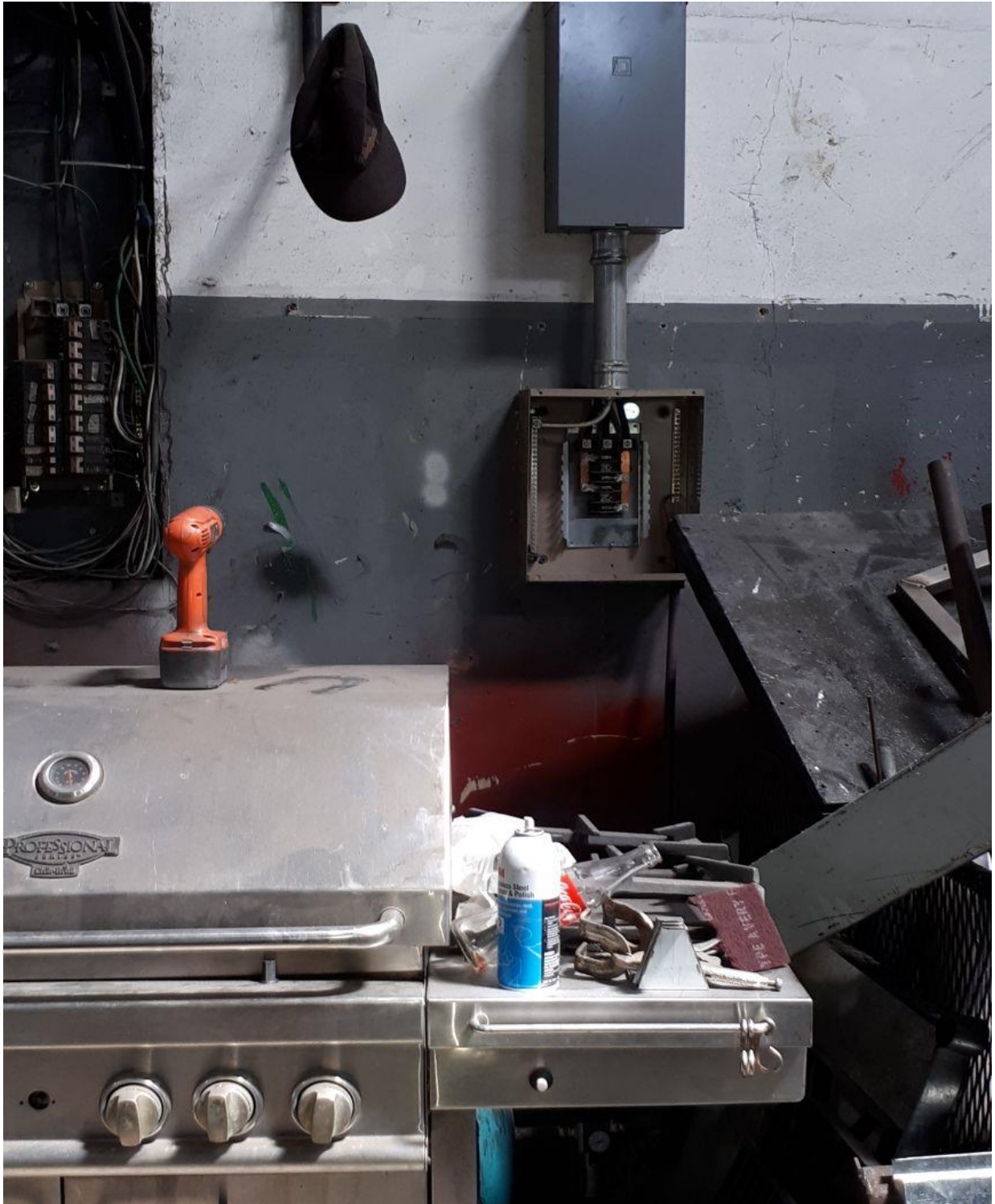
ANEXO 7: Mala organización de Equipos de trabajo.
