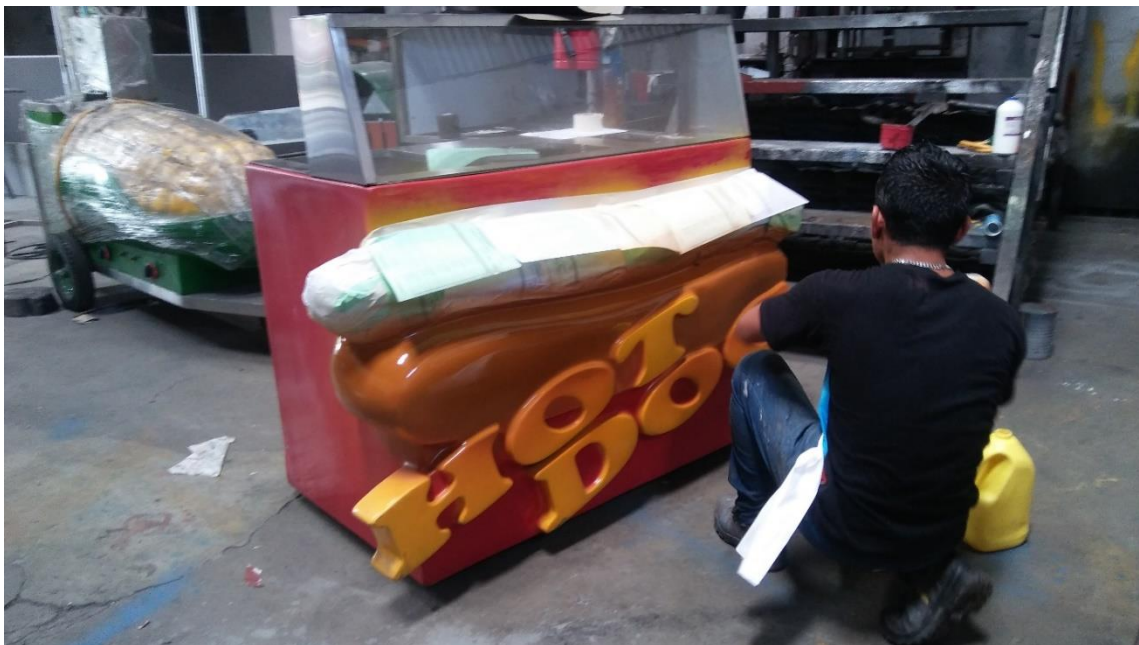
ANEXO 3: Personal de pintura sin EPP.
