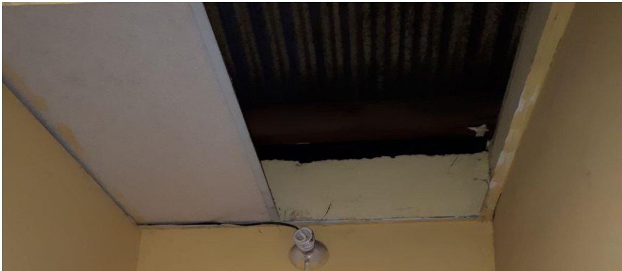
ANEXO 5: Techos de las instalaciones en mal estado
