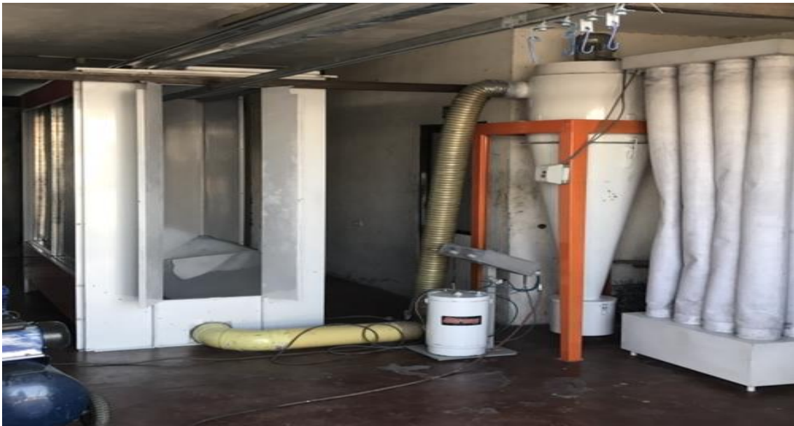
Figura 4-6. Cabina de curado para proceso de pintura.
