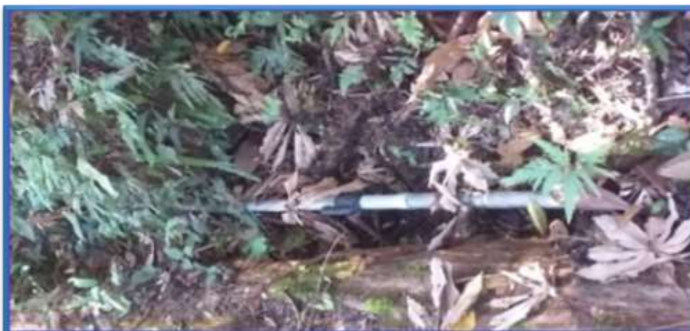
Tramos de la línea de conducción existente, donde podemos apreciar que están en mala estado, rotas y al interperie
