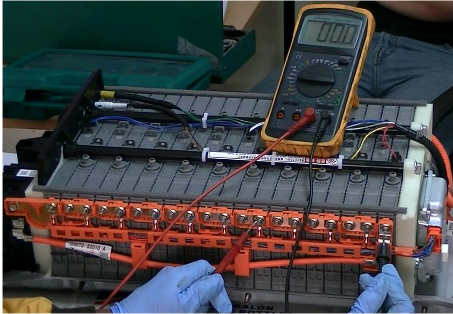
Figura 3.17 Celdas de la batería
