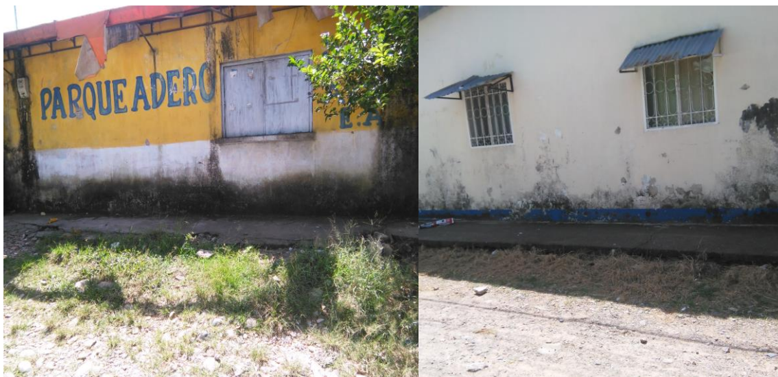
Figura 13. Efecto de la humedad sobre la infraestructura, desprendimiento de pintura y presencia de mohos en el DCS Kirpas Pinilla la Cuera. Foto tomada por: Cáceres-Leal, diciembre 2018.
