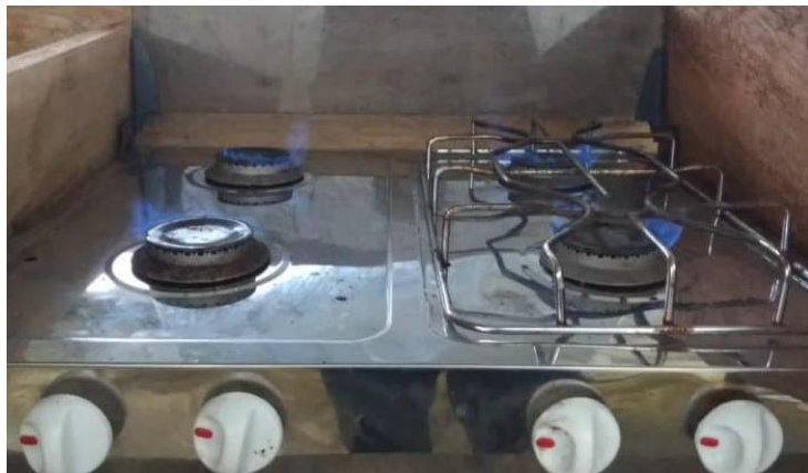
Figura 4. Utilización de biogás.
