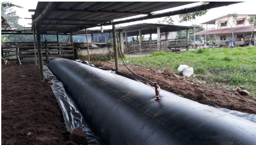
Figura 5.10. Sistema de conducción y filtrado de biogás.
