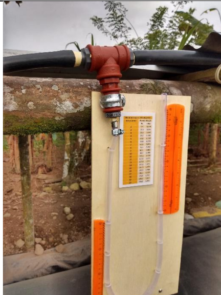
Fotografía: Manómetro de columna de agua instalado en la tubería de conducción de biogás.
