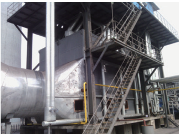
Wärmerückgewinnungsanlage in der Provinz Shandong Quelle: www.got-sun.com
