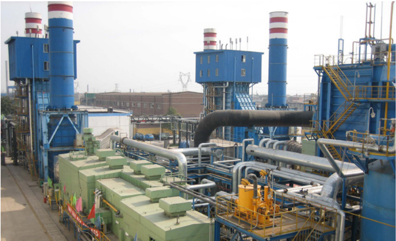
Stahlwerk mit Wärmerückgewinnungsanlage in der Provinz Hebei Quelle: www.hgjt.com.cn
