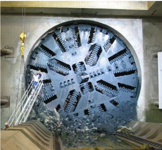
Tunnelier (Ø 11 m, A68, 2005) Céramiques thermomécaniques
