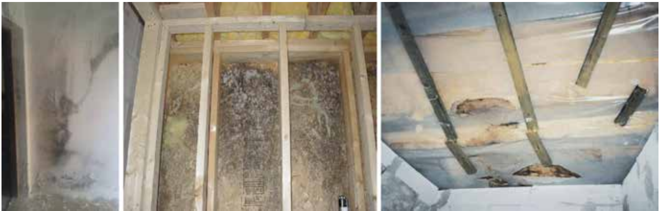
Slika 7. Razvoj gljivica i plijesni na površini (lijevo) i unutar (sredina i desno) građevnih dijelova zgrade
