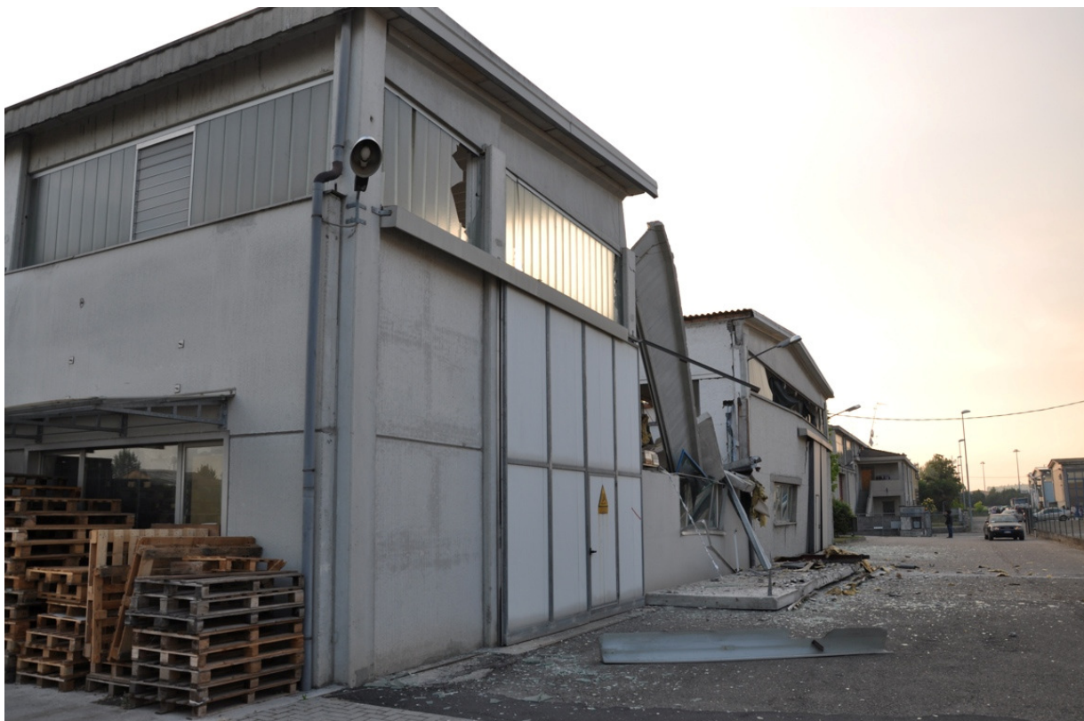
Figura 2. Edificio SERITAL danneggiato dal sisma del 2012
