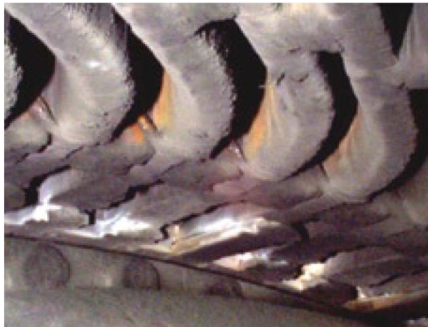
Figura 47. Presencia de polvo blanco resultado de descargas corona.
