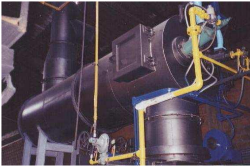
Cámara de Post combustión
