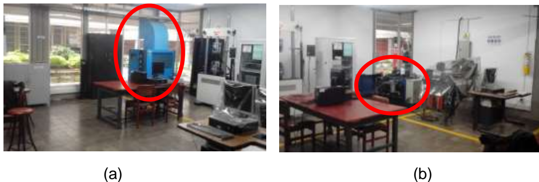
Figura 28. Emplazamiento de las fuentes ruidosas (encerradas en rojo) (a) chiller y (b) bomba
