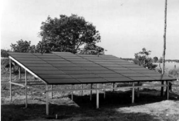
Figura 3. Sistema solar Fotovoltaico, instalado en 1996 en la Venturosa Vichada.
