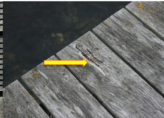
Robinia med spricka och konstaterat angrepp av soft rot röta
