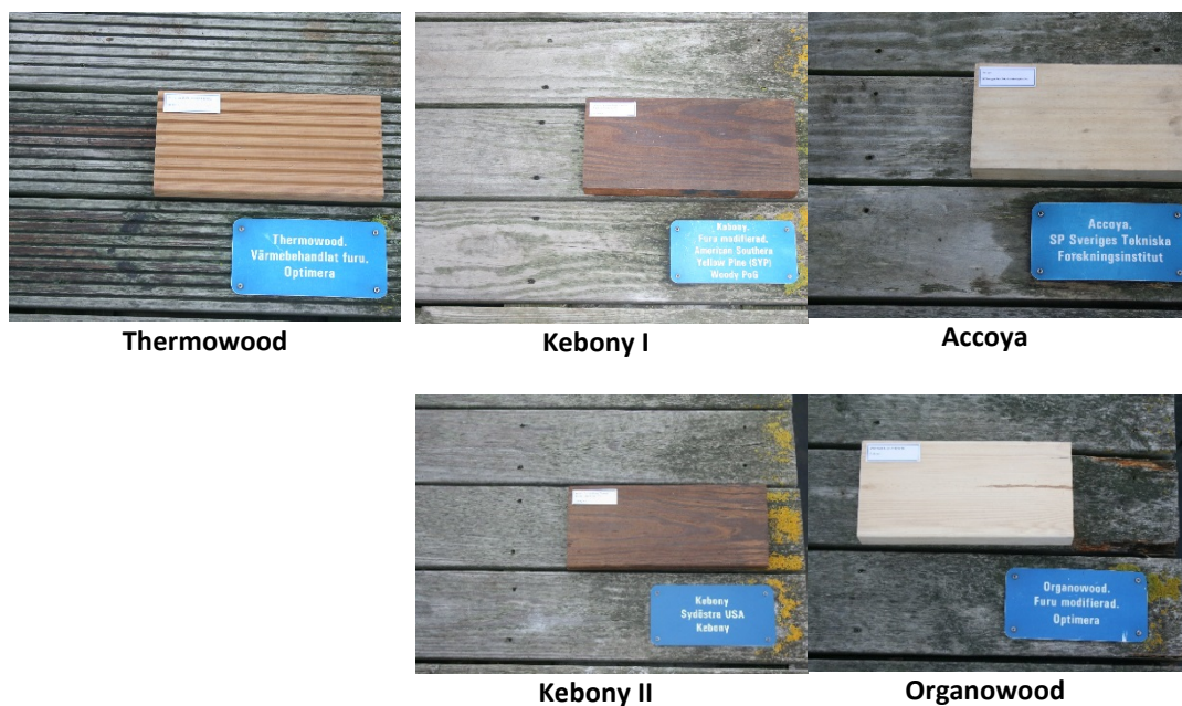
Figur 12. Utseende hos det modifierade träet vid inspektionen 2019.
