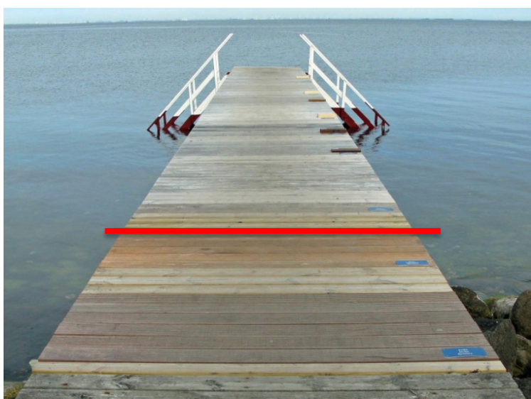
Figur 2. Brygga K, 2014-06-10, kompletterad med trämaterial installerade 2014-03-14 (under det röda strecket).
