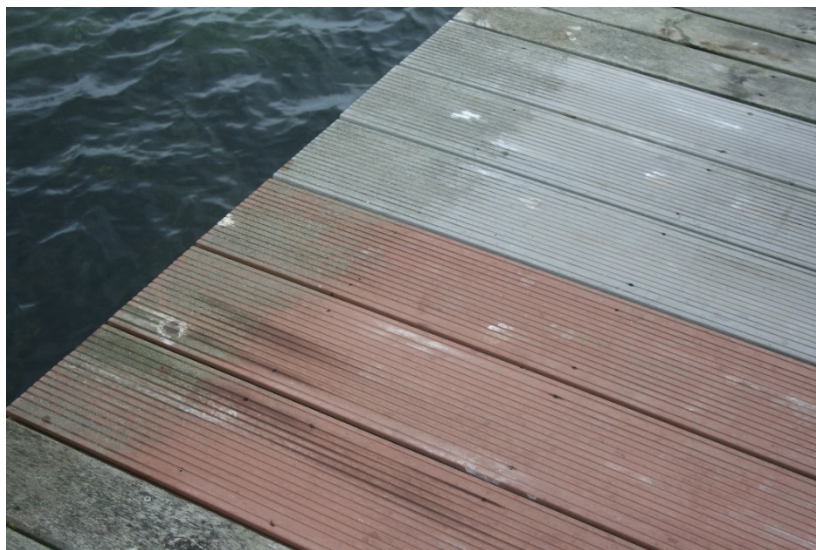
Figur 25. Påväxt i ytterkant av Green Plank grå och röd. Fläckar av fågellort som biter sig fast i rillor framträder också tydligt.
