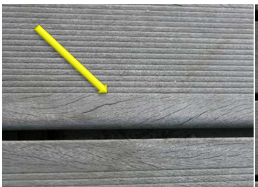
Cumaru med många små sprickor Foto från inspektionen i oktober 2018
