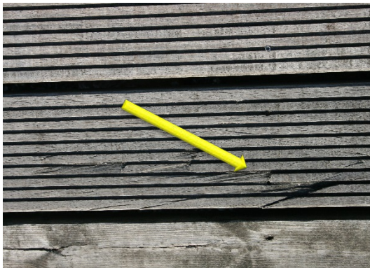
Azobé med sprickor och uppfläckning i rillor Foto från inspektionen i oktober 2018
