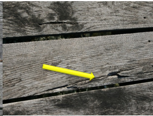
Robinia med kraftig kantspricka Foto från inspektionen i oktober 2018
