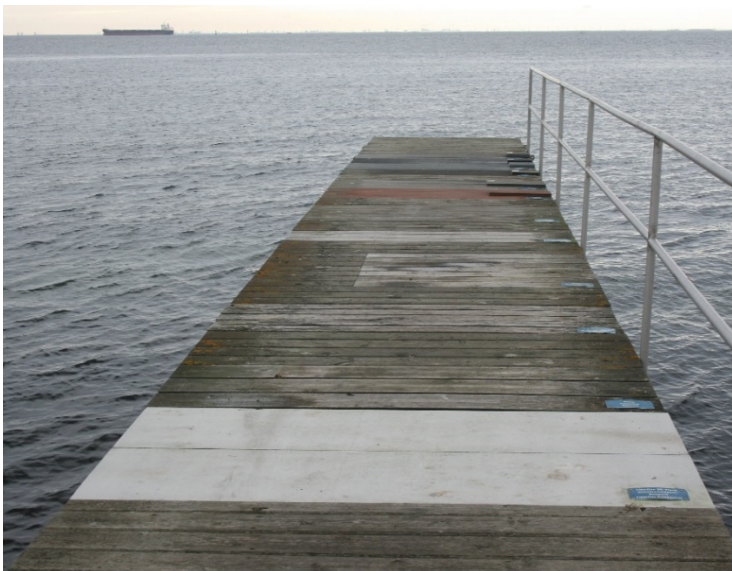
Figur 6. Brygga J, 2019-10-23, kompletterad med Fiberline (vita skivan), som installerades under våren 2016.
