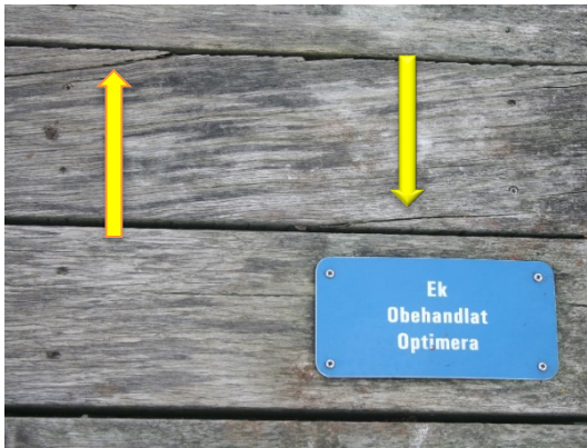
Ek med kantsprickor
