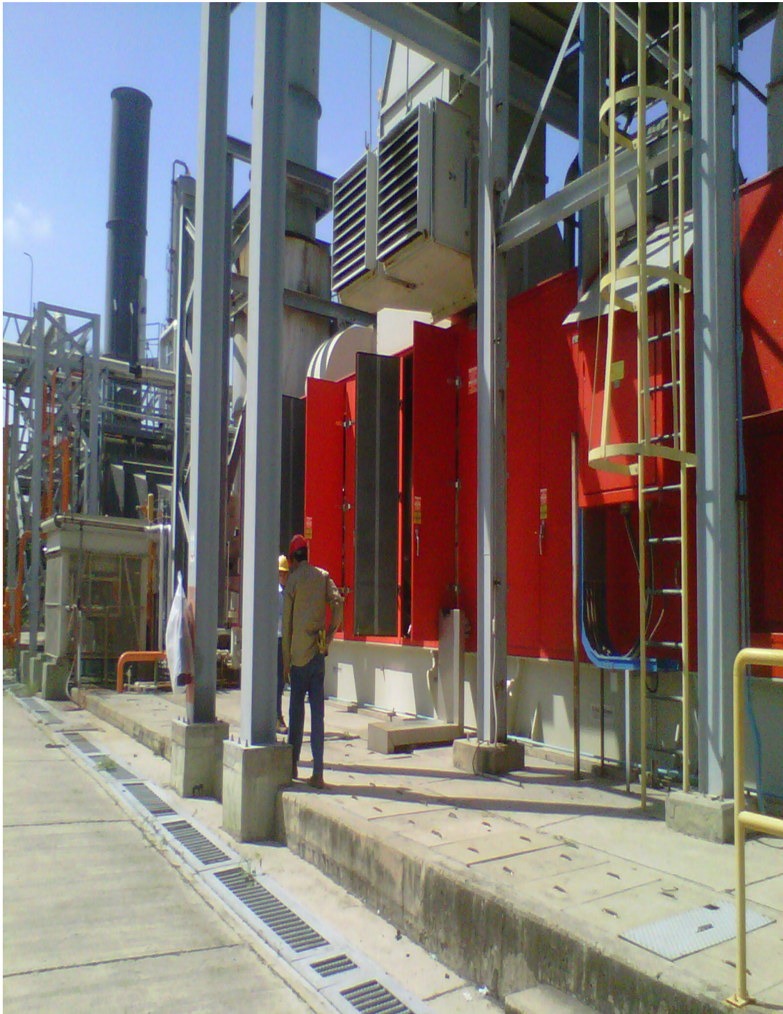
Imagen 2. Bloque de cogeneración con turbina a gas en la empresa ABOCOL-Cartagena.
