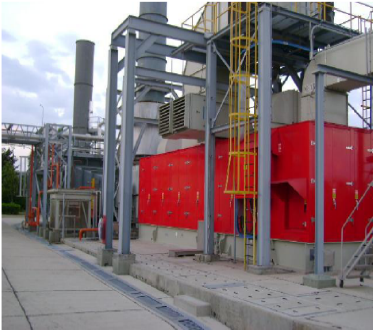
Imagen 13.bloque cogenerador con tubina a gas TG y caldera recuperadora de calor HRSG del área de servicios industriales de la empresa ABOCOL-Cartagena.
