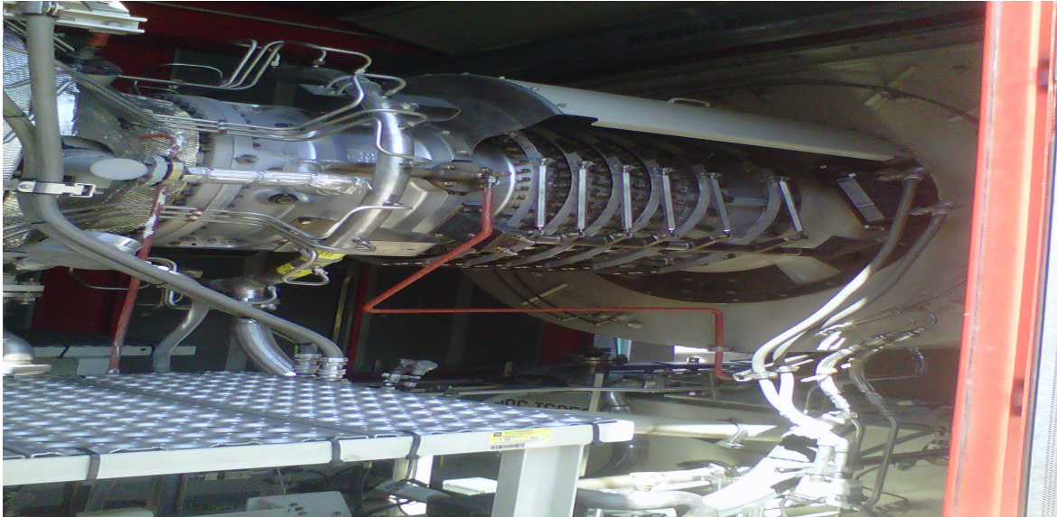
Imagen 8. Cámara de combustión de la empresa Abocol-Cartagena [6]
