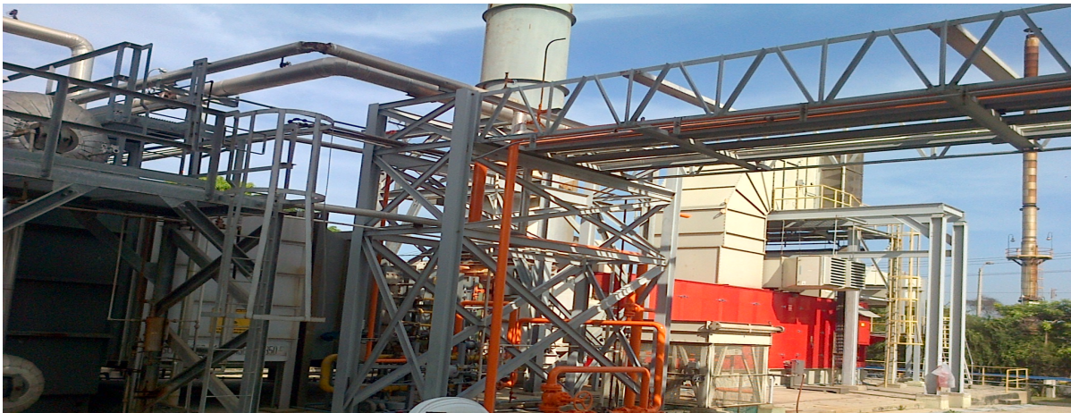
Imagen 1. Bloque de Cogeneración de la empresa ABOCOL-Cartagena
