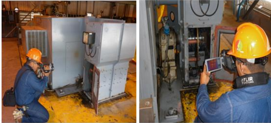
Figura 23 Electricista termógrafo de la refinería de Cartagena
