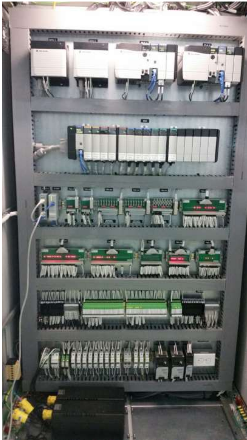
Imagen 32 Panel de Control Redundante
