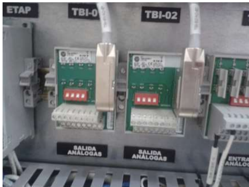
Imagen 27 Modulo Pre cableado de Salidas Análogas
