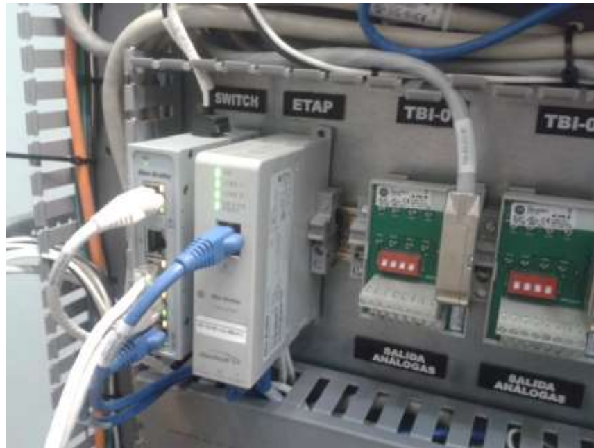
Imagen 26 Switch de Ethernet y modulo ETAP
