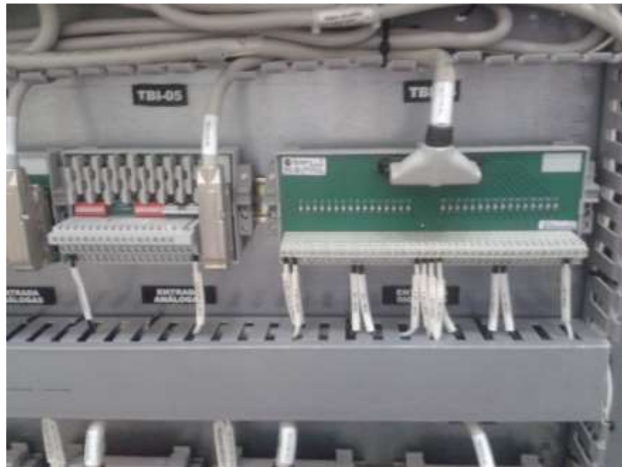
Imagen 28 Modulo Pre cableado de Entradas Análogas y Entradas Digitales
