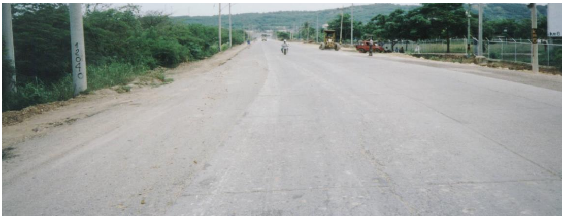
Ilustración 21. Estado de la Vía Mamonal Antes del Corredor de Carga
