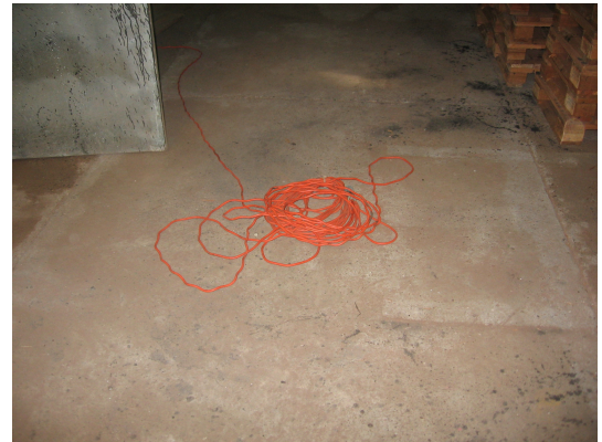
Cable ubicado en el piso de la zona de cuarentena.
