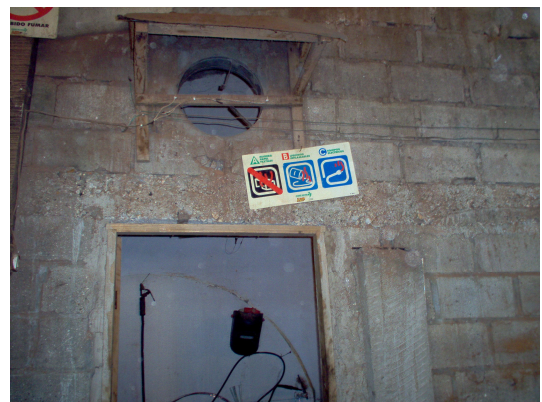
Paredes sucias y señalización en mal estado.
