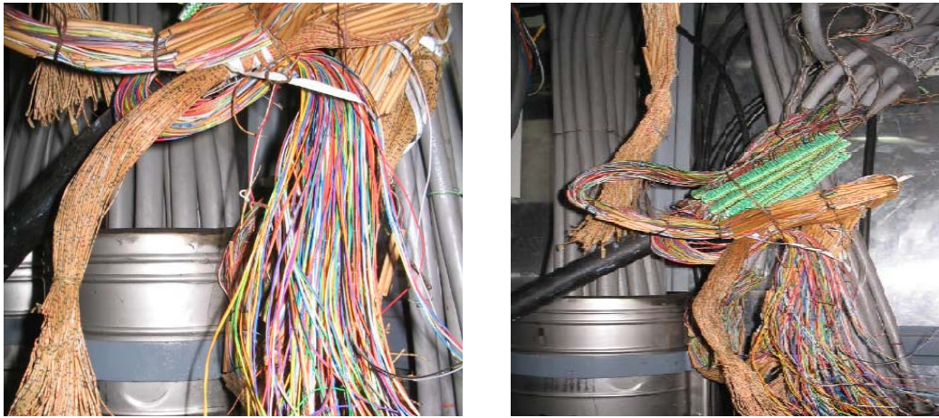
Figura 36. Cable con aislamiento de papel
