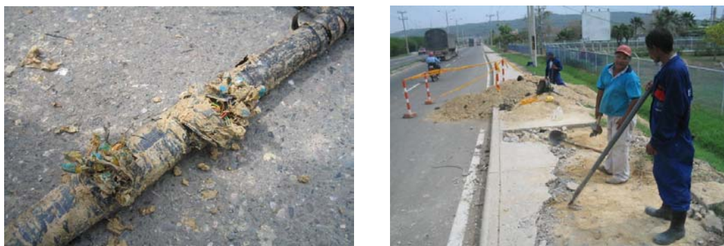
Figura 51. Daños por obras civiles
