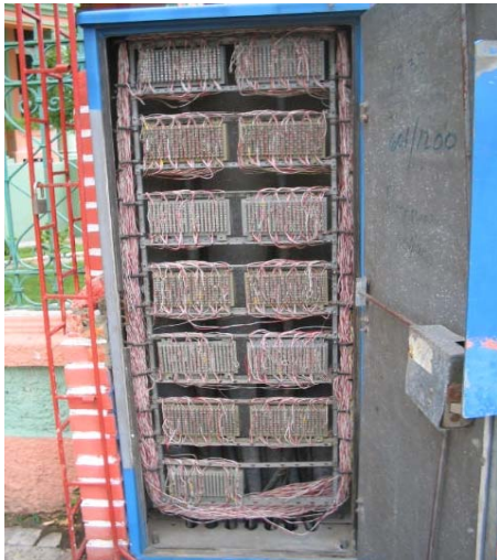
Figura 18. Armario o punto de distribución
