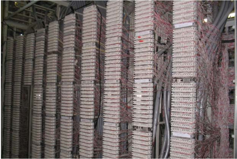
Figura 14. Bastidor de distribución primaria y secundaria
