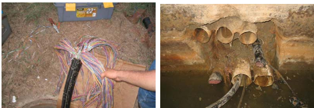
Figura 49. Robo de cable multipar
