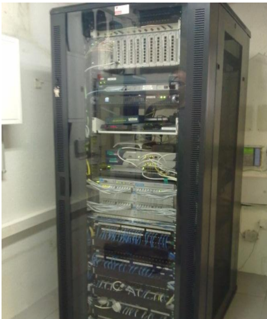
Figura 26: Gabinete de Telecomunicaciones
