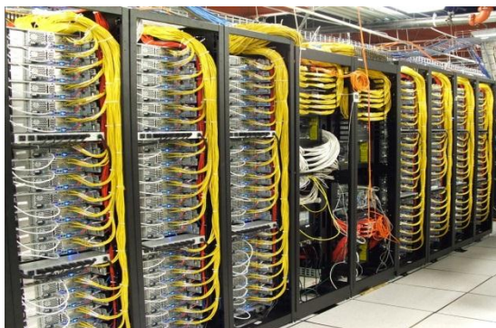
Figura 22: Sistema de Cableado estructurado
