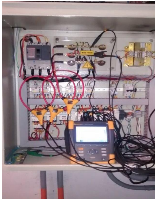
Figura 61. Montaje general del Analizador de red en el tablero eléctrico de Potencia y Control de las bombas centrífugas. Fuente: Elaboración propia.
