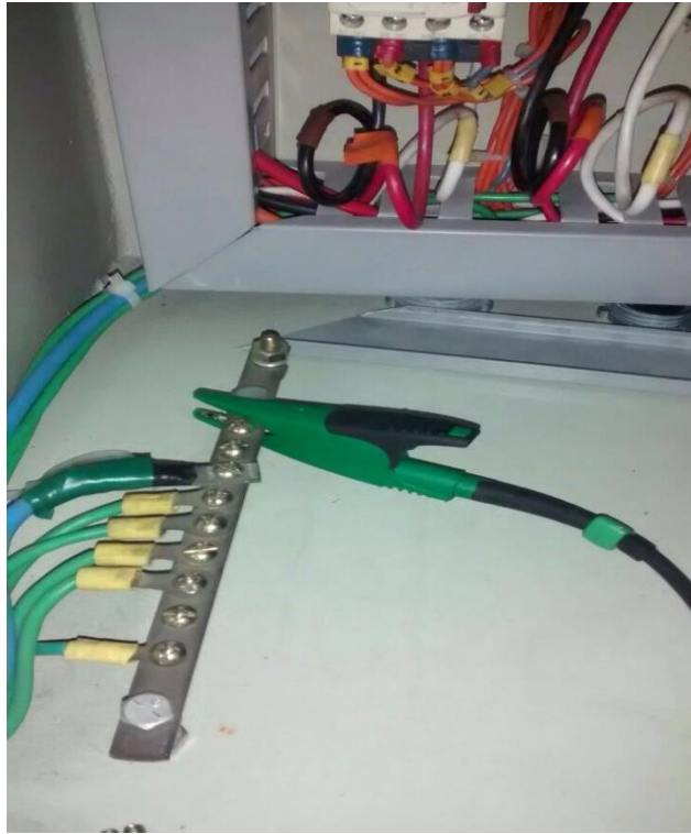
Figura 63. Conexión a tierra en el tablero eléctrico de Potencia y Control de las bombas centrífugas. Fuente: Elaboración propia.
