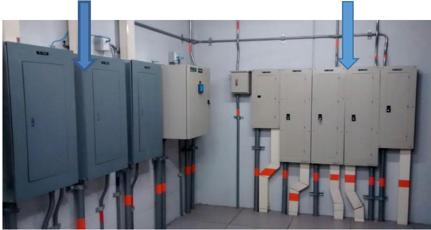
Figura 107. Cuarto Eléctrico Piso 6 Sector C, Bancolombia Dirección General. Fuente: Elaboración propia
