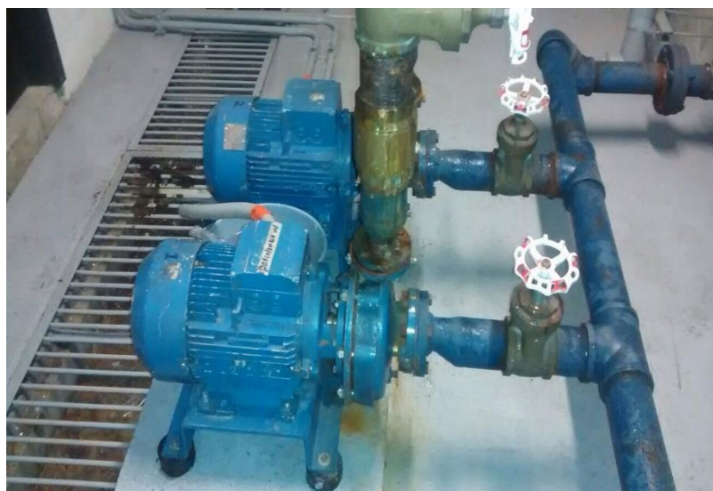
Figura 2. Bombas Centrífugas, sótanos Torres Norte y Sur. Fuente: Elaboración propia.
