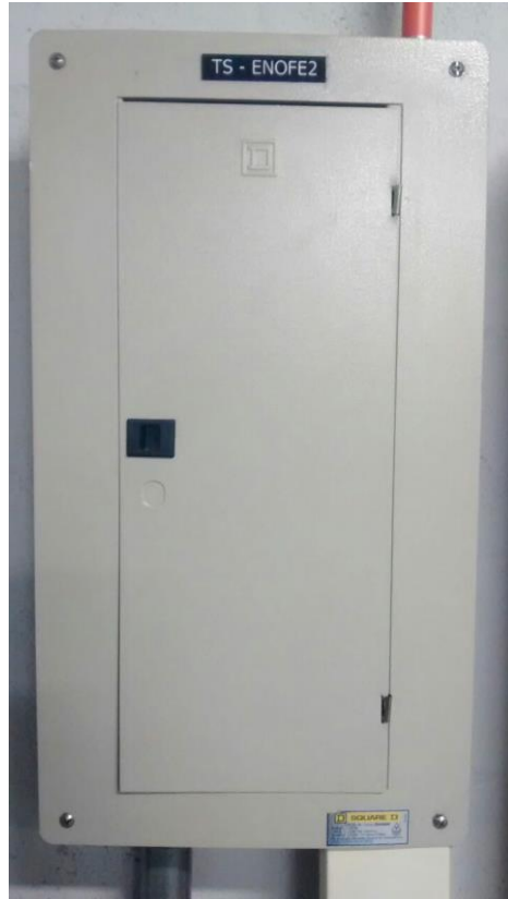
Figura 55. Tablero de energía normal. Fuente: Elaboración propia
