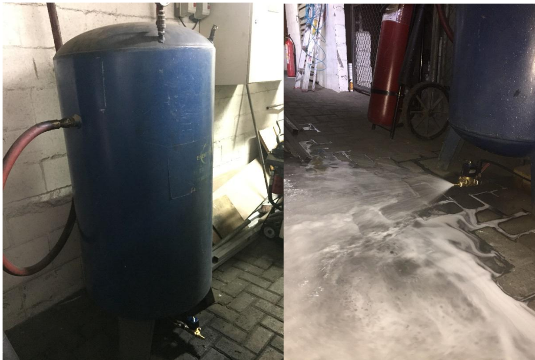
Figura 9. Acumulador con desahogo automático
