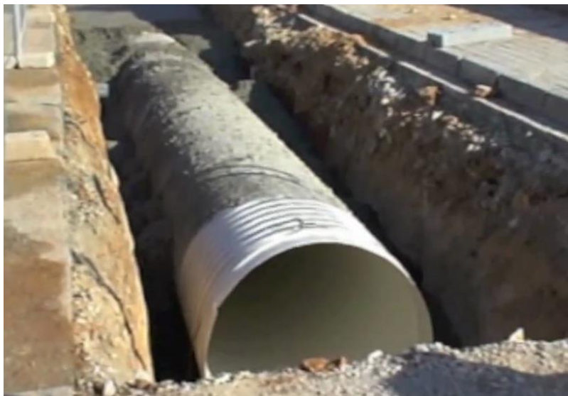
Figura 8-37 Colector de agua enterrado.
