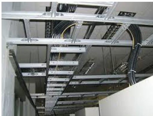
Figura 8-7 Cables sobre bandejas
