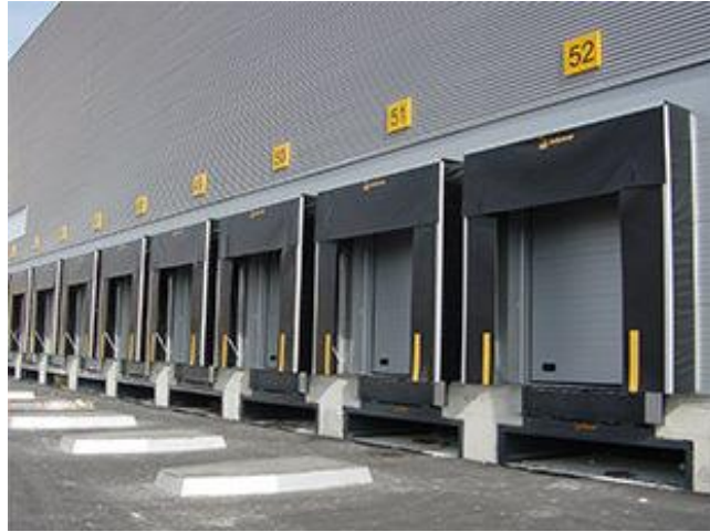
Figura 4-25 Abrigos para Muelles de Carga
