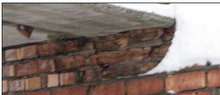
Рисунок 8. – Размораживание кладки опорных зон плит перекрытия
