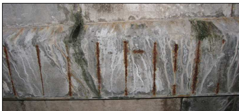
Рисунок 5. – Оголение поперечной арматуры ригелей
