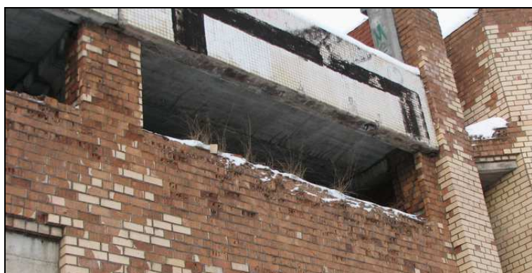
Рисунок 7. – Размораживание подоконных участков наружных стен
