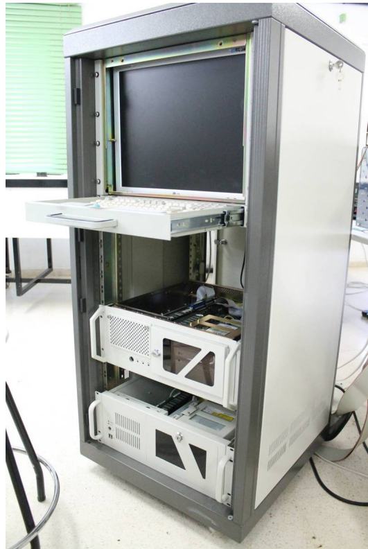
Figura B.18. PC Industrial con la tarjeta dSPACE DS1103 instalada.
