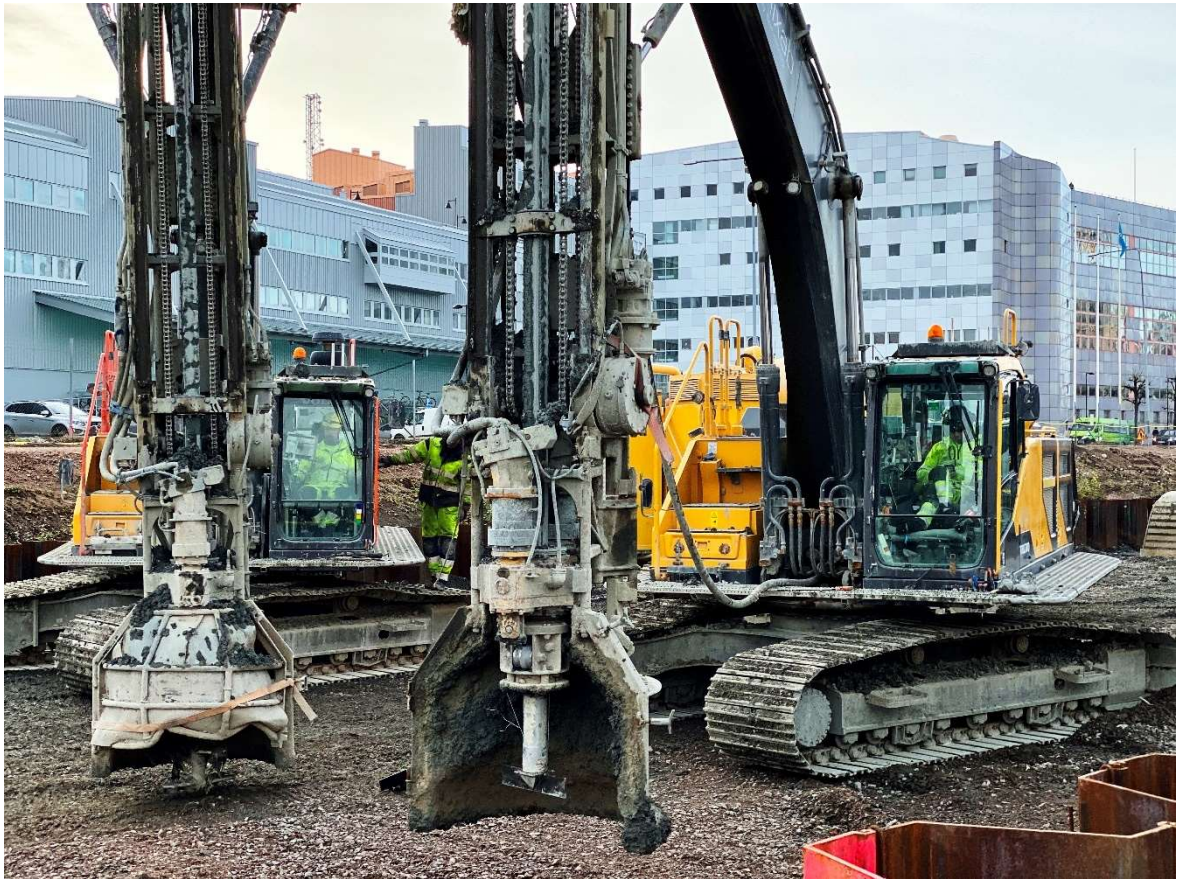
Figur 3. Uppföljande fälttester med ERT i Göteborg, hösten 2019. Här installerades specialdesignade, relativt billiga, ERT-kablar i KC-pelare. Riggen till vänster är redo att börja producera KC-pelare medan den högra riggen står beredd att direkt installera bottenförankringsdon och mätkabel.
