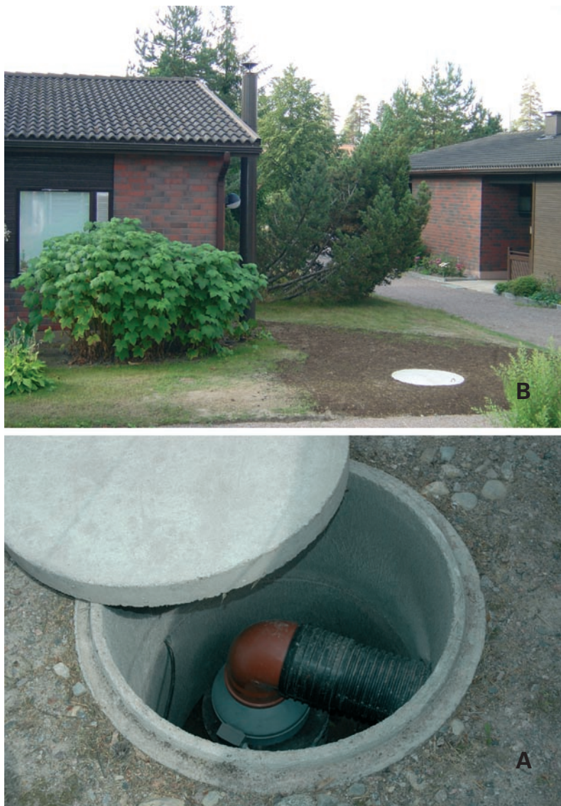
Bild 5.7. Avluftsfläkten placerad i en brunnsring (A) samt brunnslocket och avluftsröret som når ända upp över taksågget (B).
