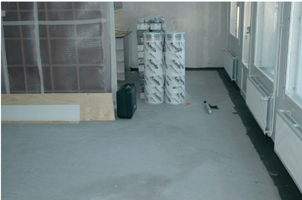
Bild 6.5 Tätning av alla golvfogar med tätskikt och förstärkningsband i ett småhus. På grund av det synnerligen grova fyllnadsmaterialet fungerade radonsugen inte som avsett i saneringsobjektet.
