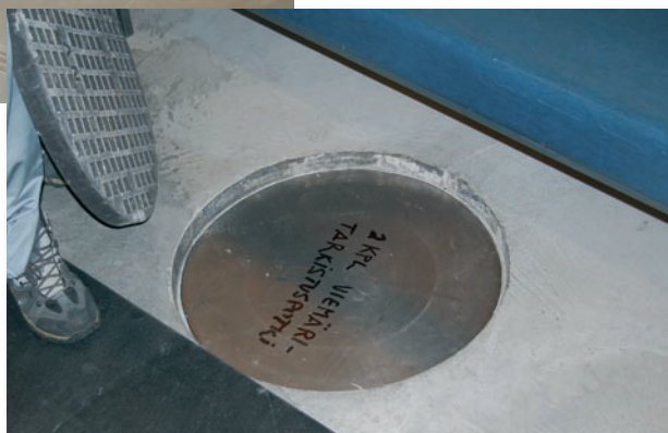
Bild 11.2 På bilden har ett läckande lock på kontrollbrunnen för täckdiken tätats genom att det stängts med ett tätat metallock.
