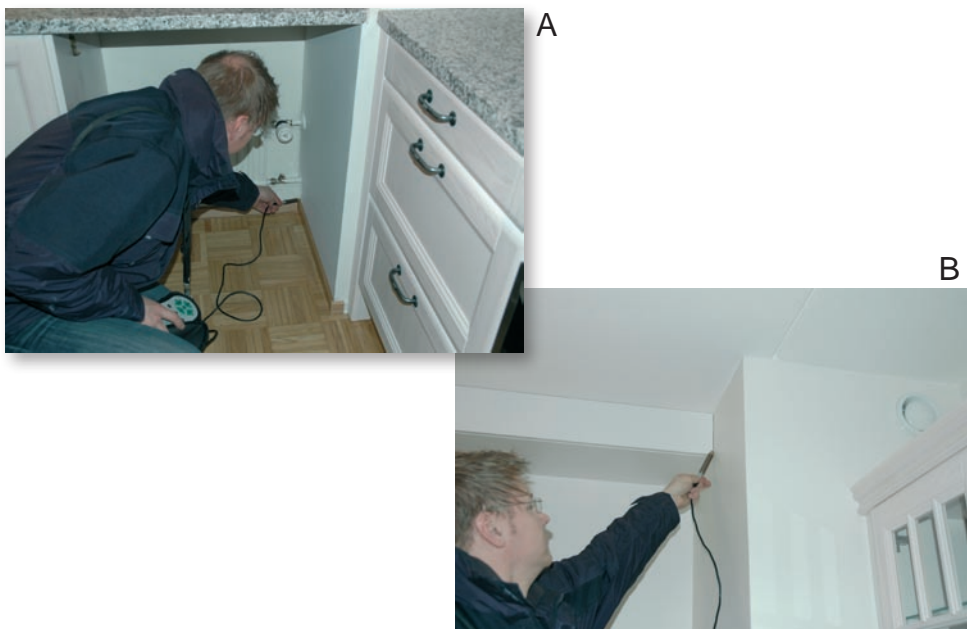
Bild 12.4. Letande efter radonläckage i fogen mellan golv och rörkanal (A). Också springan mellan golvet och väggen läckte. Vatten- och avloppsrörkanaler visade sig vara betydande inströmningsvägar. Rörkanalen är förbunden med ventilationsinkapslingen längs vilken den radonhaltiga luften sprids ut i andra utrymmen (B).
