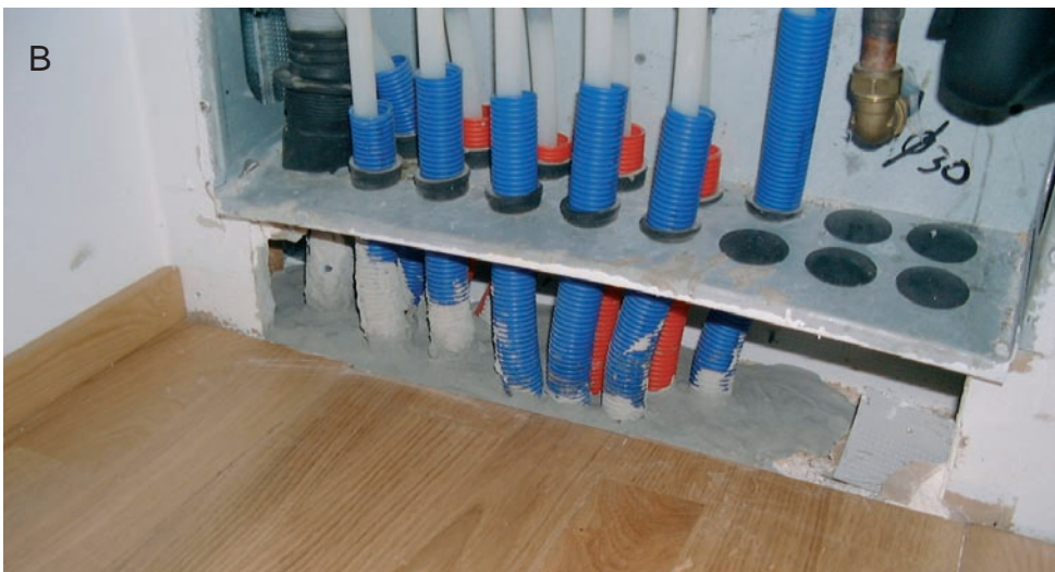
Bild 6.6 Otätad genomföring i samband med vattenledningsfördelaren i ett småhus. Det var direkt kontakt från mellanrummet mellan skyddsroren till värmeisoleringen och fyllnadsgruset (A). Tätningen utfördes med synnerligen flytande spackelmassa (B).
