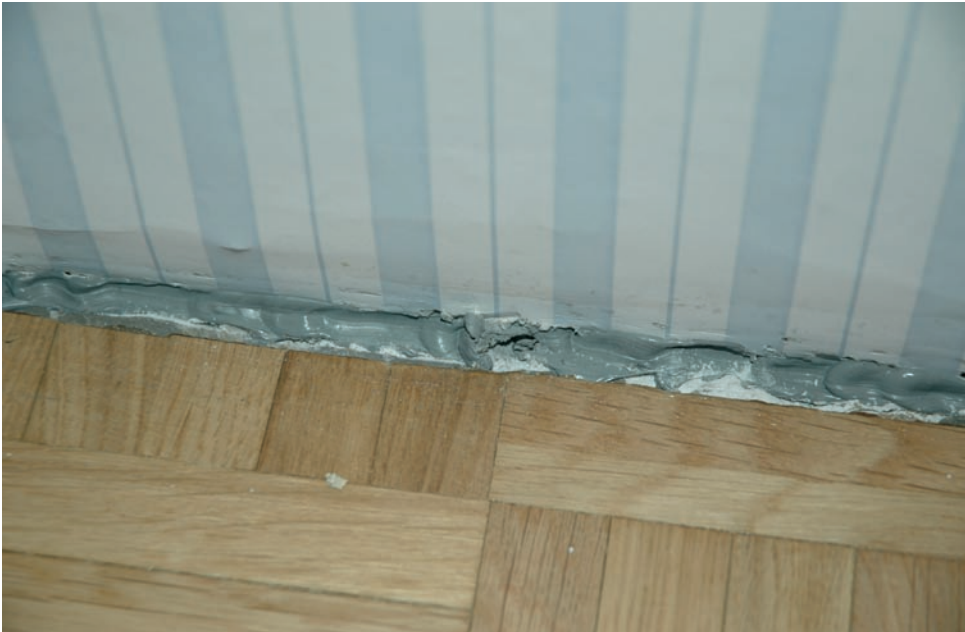
Bild 6.2 På bild visas en misslyckad tätning. Springan under golvlisten som skall fogas har inte utvidgats eller rengjorts.
