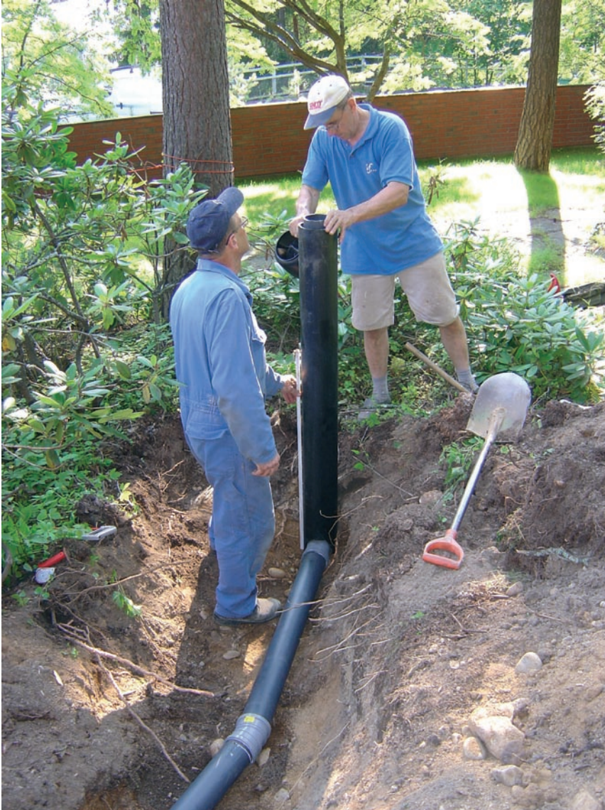
Bild 5.15 Radonbrunnens värmeisolerade avluftsror på gården. Även de horisontala delarna värmeisolerades.
