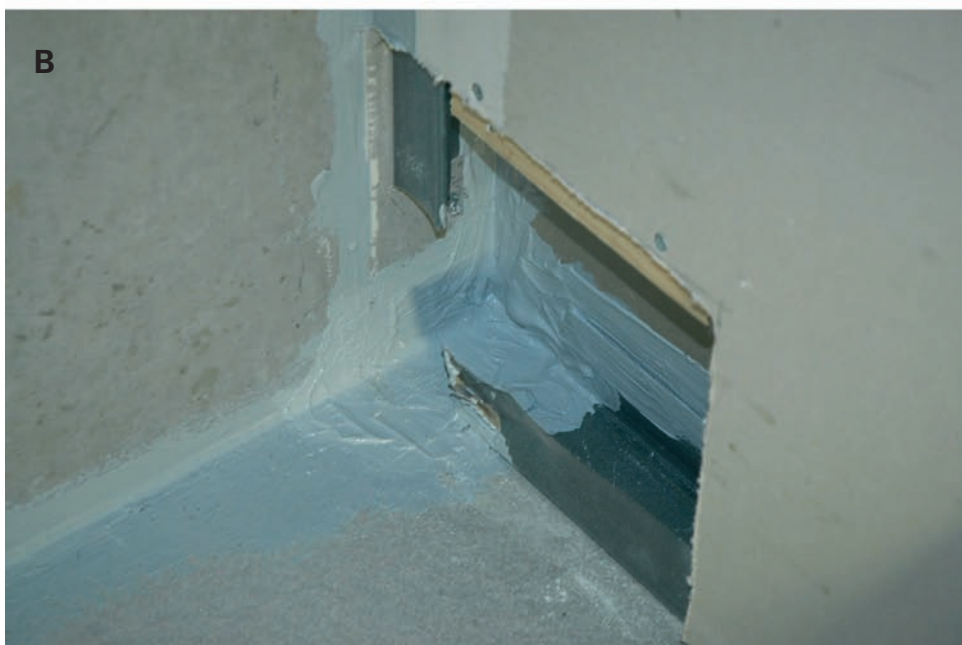
Bild 6.4 Tätning inne i en mellanvägg utförd med tätskikt. Isoleringsremsan av cellplast som syns på bilden mellan plattan och grundmuren förhindrar inte att radonhaltig luft tränger in.
