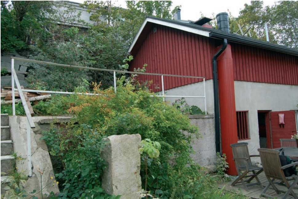
Bild 5.11. Ett avluftsror från en radonbrunn invid väggen på ett förråd på Pispala ås.
