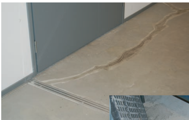
Bild 11.1 Sprickorna i golvet i källargången i en universitetsbyggnad tätades med en ytbeläggning av epoxi.
