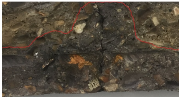
b: M 0.5-crack width 0.1 mm
