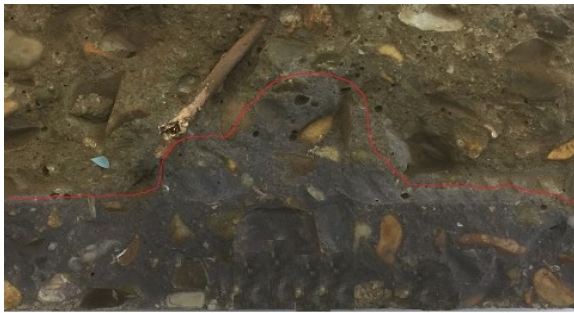
a: M 0.4-crack width 0.1 mm
