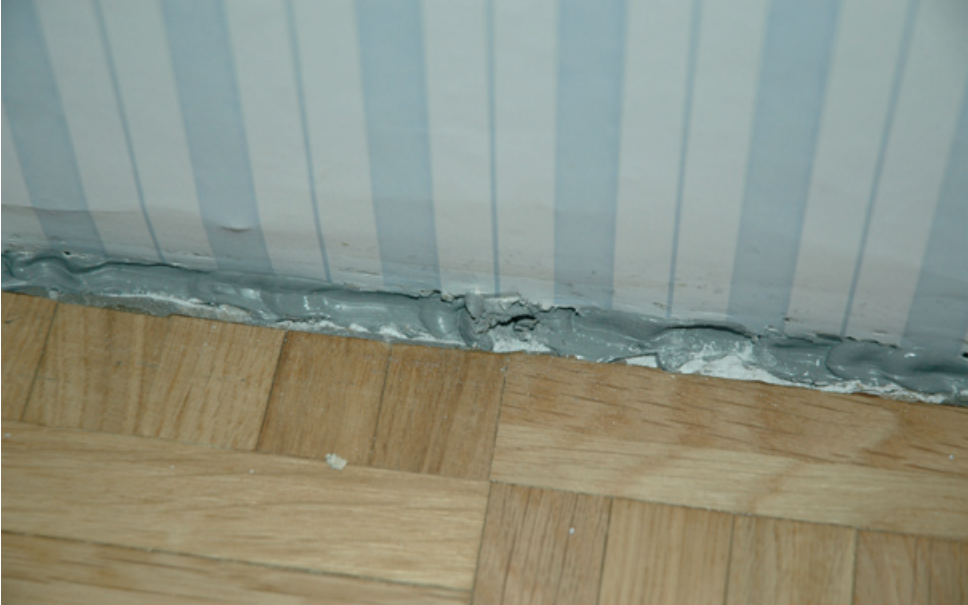
Kuva 6.3. Epäonnistunut tiivistäminen, jossa lattialistan alla olevaa saumattavaa rakoa ei avarrettu ja puhdistettu.
