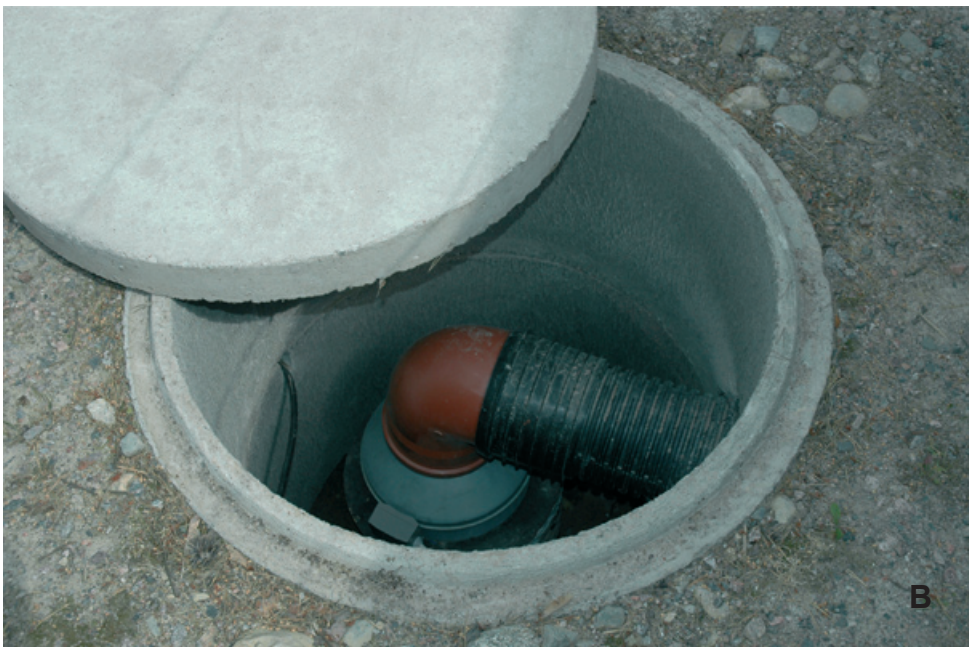
Kuva 5.7. Kaivonrenkaaseen sijoitettu poistopuhallin (B) sekä kaivon kansi ja korkea räystäään yläpuolelle asti ulottuva poistoputki (A).
