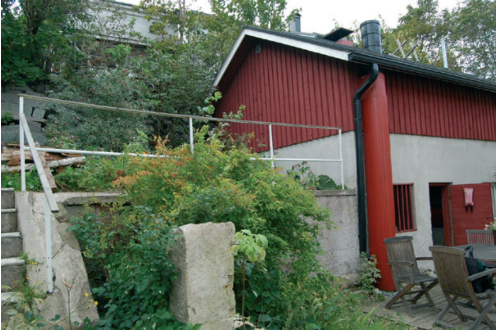
Kuva 5.10. Radonkaivon poistoputki vajan seinustalla Pispalanharjulla.
