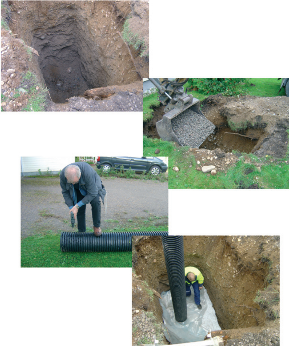
Kuva 5.12. Radonkaivon kuoppa, sepelitäyttöä, kaivoputken alaosan poraaminen sekä muovin asentaminen sepelitäytön ja suodatinkankaan päälle.
