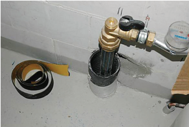
Kuva 6.2. Tiivistämätön päävesijohdon läpivienti.
