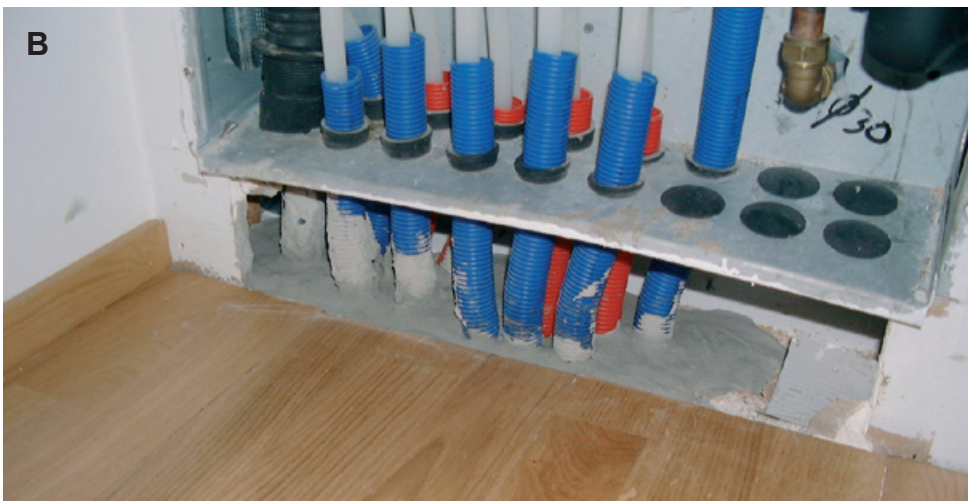
Kuva 6.7. Tiivistämätön läpivienti pientalossa vesijohtojen jakotukin yhteydessä. Suojaputkien välistä oli suora yhteys lämmöneristeeseen ja täyttösoraan (A). Tiivistystyö suoritettiin erittäin juoksevilla tasoitemassalla (B).
