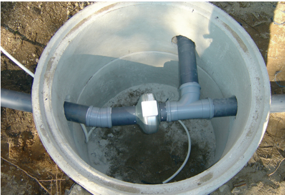
Kuva 5.14. Kahden erillisen imuhaaran liittymä ja kanavapuhallin kaivonrenkaassa.
