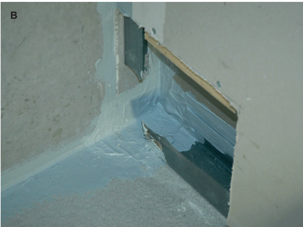
Kuvat 6.5. Vedeneristysmassalla tehty tiivistystyö väliseinän sisällä. Kuvassa perusmuurin ja laatan välissä oleva solumuovinen eristysnauha ei estä radonpitoisen ilman vuotoja.
