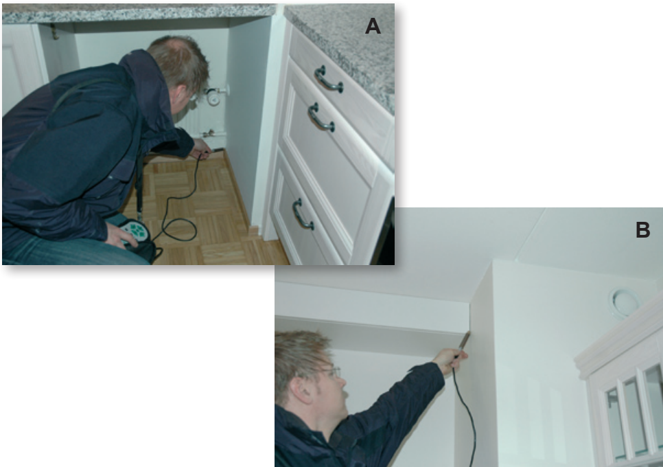
Kuva 12.4. Vuodon etsintää lattian ja putkistokanavan liitoksesta (A). Myös lattian ja seinän välinen rako oli vuotava. Vesi- ja viemäriputkikanava osoittautui merkittäväksi vuotoreitiksi. Putkikanava on yhteydessä ilmanvaihtokotelointiin, jota myöten radon-pitoinen ilma leviää muihin tiloihin (B).
