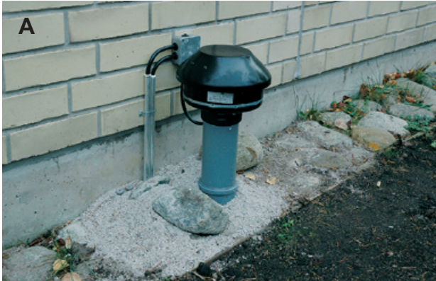
Kuva 10.6. Sokkelin viereen asennettu poistopuhallin (A) ja puhaltimen ympärillä oleva tehokas äänenvaimennin (B).
