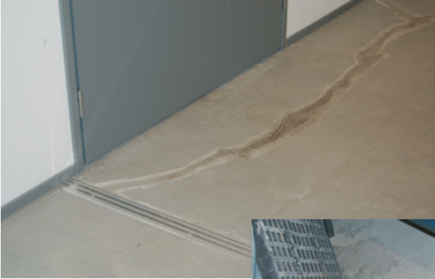
Kuva 11.1. Yliopistorakennuksen kellarikäytävän lattian halkeamien tiivistäminen suoritettiin epoksi-pinnoitteella.
