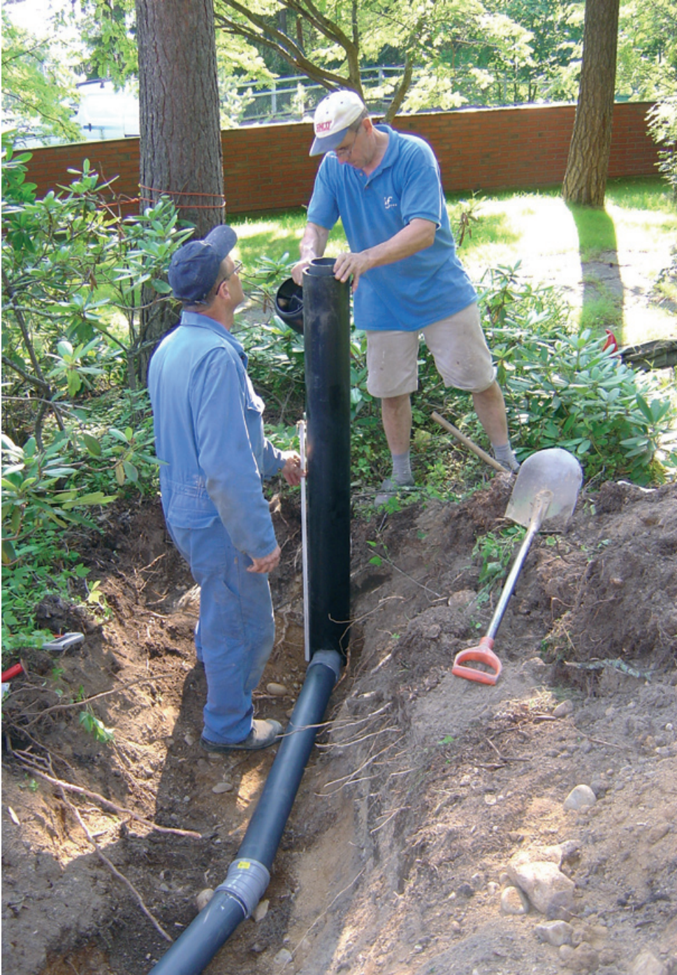
Kuva 5.15. Radonkaivon lämpöeristetty poistoputki pihamaalla. Myös vaakaosuudet lämpöeristettiin.
