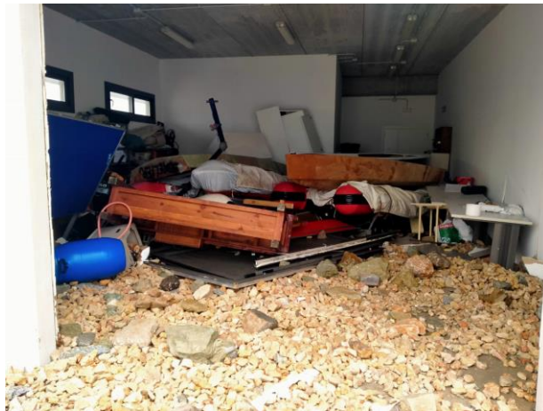
Figura 151. Taller afectat per l'impacte de les onades del temporal Glòria. Font: pròpia.
