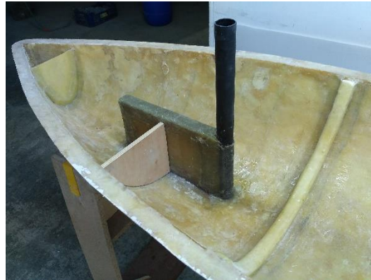
Figura 140. Instal·lació de l'enfognament soldat a popa del calaix de l'orsa. Font: pròpia.
