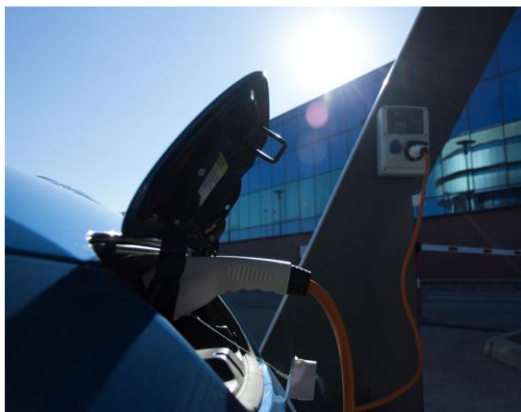
Imatge 33 Wallbox o caixa de recarrega.
