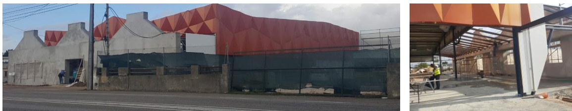
Figura 125 - Fase de obra aquando da adjudicação com a U.O. Fonte: Biblioteca atelier
