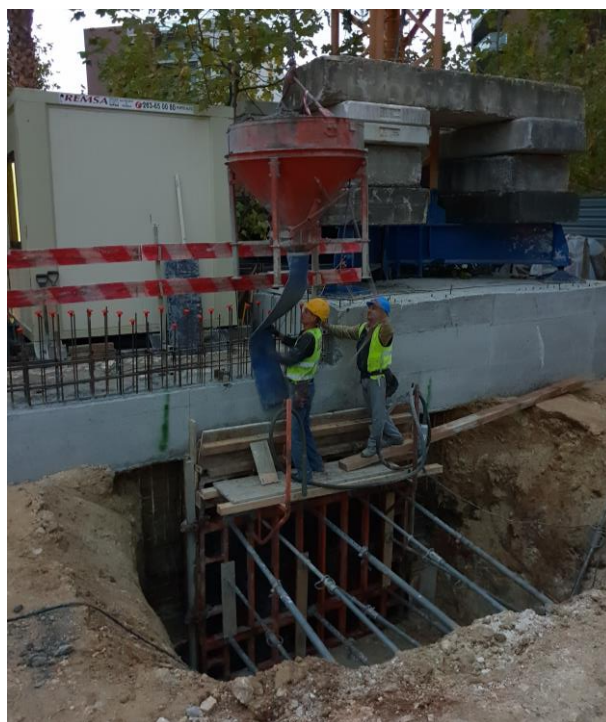
Figura 3.48 - Plataforma com ausência de guarda-corpos
