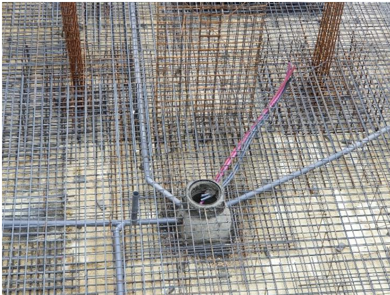
Figura 3.66 - Poço de bombagem
