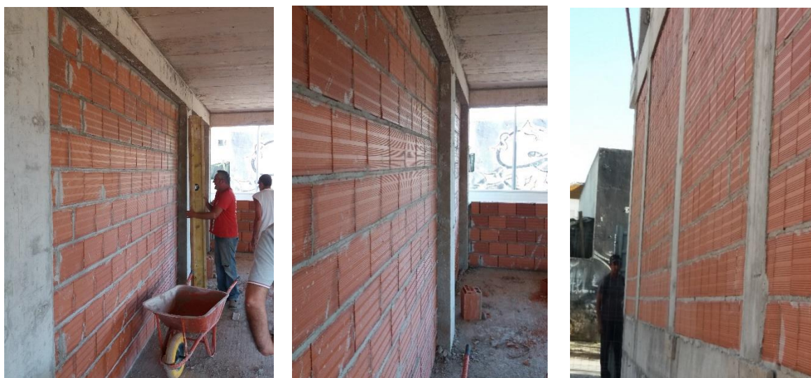
Fig. 3.4.a) - Tarefa subcontratada com pano de parede exterior não aprumado
