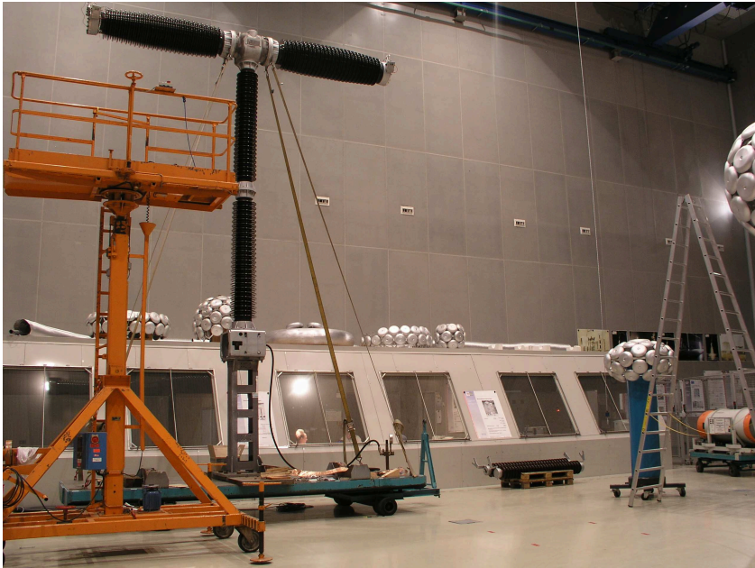
Abbildung 4-26: 2. Brückenmessung: Schalter an der Warte
