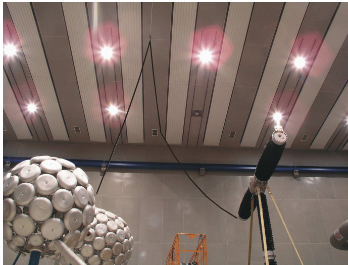
Abbildung 4-24: 1. Brückenmessung: Leitungsführung zur Mitte des Schalters (Pol 1)
