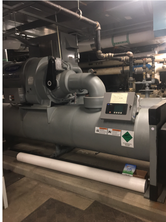
Fig. 3.2.: Eiteljorg's Carrier 19XRV 300 Ton Chiller
