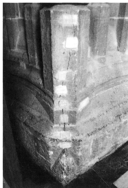
Fisuras en los pilares.
