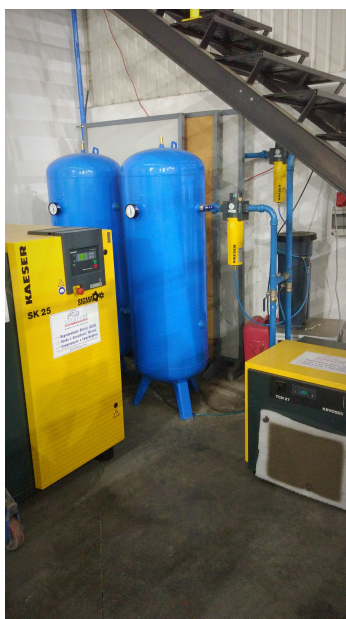
Figura 2.4: Instalação da unidade compressora existente na empresa
