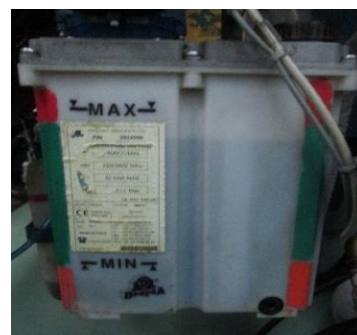
Figura 43 – Reservatório do óleo de lubrificação
