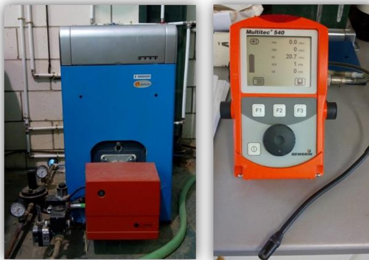
Figura 4.14. Equipo de medición de composición de biogás portátil (derecha) y caldera de combustión de biogás (izquierda).
