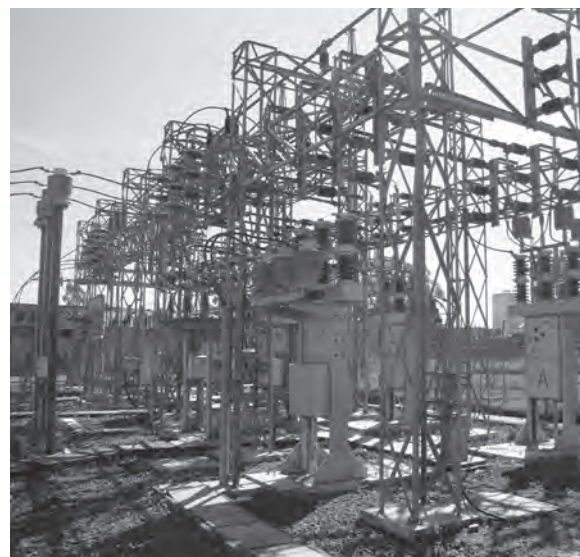
Figura 8. Posición de los disyuntores de 23 kV de la S/E Pomasqui.
