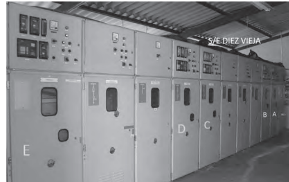
Figura 5. Posición de las cabinas de 6,3 kV en la S/E Diez Vieja
