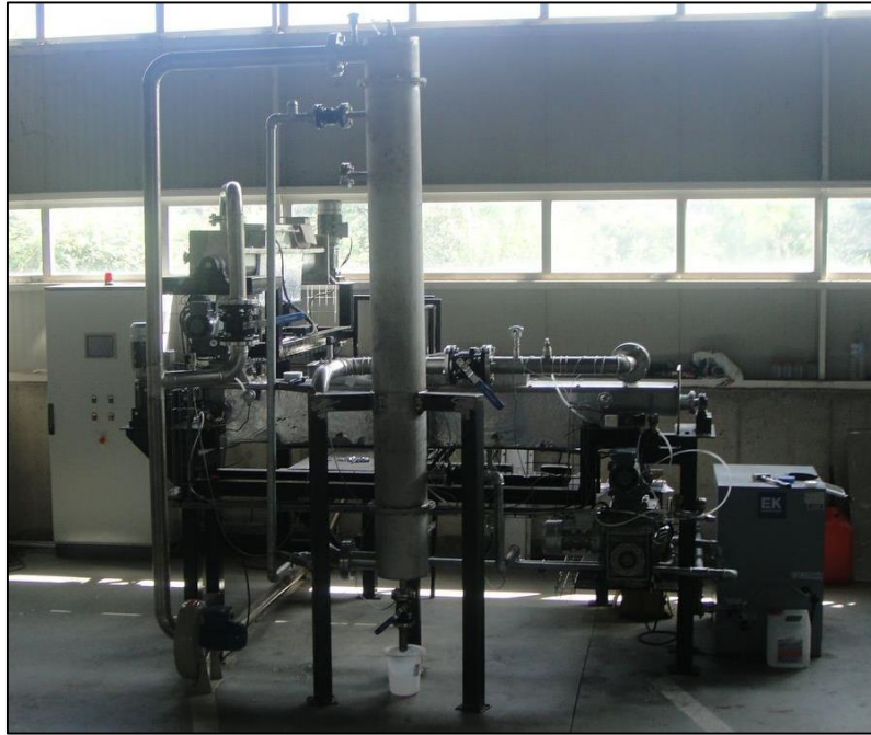
Figure 3.9. Picture of Energies Tèrmiques Bàsiques biomass conversion plant.
